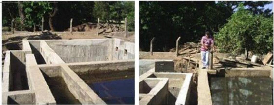
Figura 8. Planta de tratamiento de agua potable
