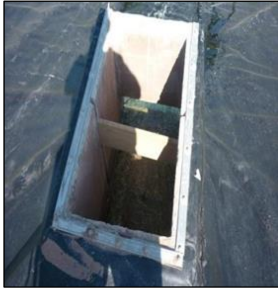
Figura 15. Cajas de Interconexión
