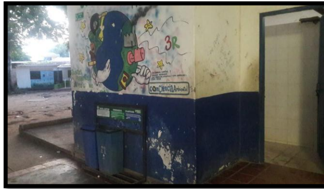
Ilustración 10 Puntos ecológicos deteriorados
