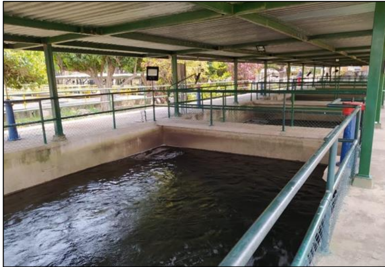
Fotografía 7. Unidades de filtración de la PTAP La Gota Fría
