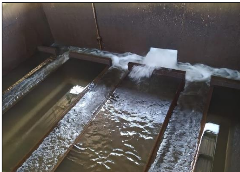
Fotografía 8. Unidades de filtración de la PTAP La Gota Fría
