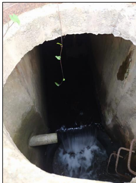
Fotografía 17. Macromedidor Aledaño a la PTAP La Gota Fría
