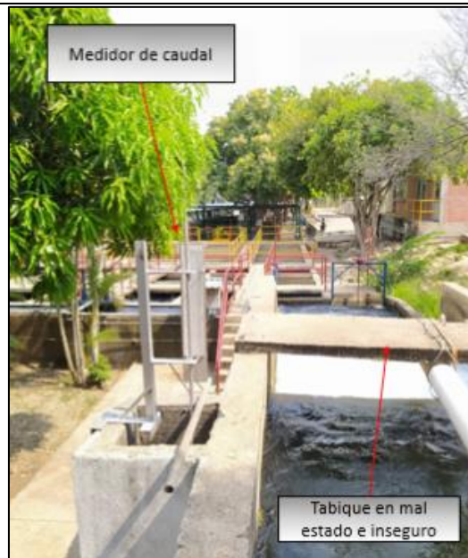
Figura 6. Condiciones inseguras en unidad de Mezcla Rápida
