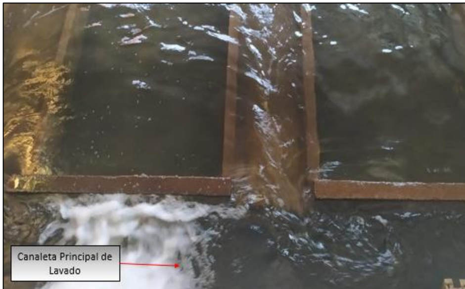
Figura 13. Canaleta principal de lavado en los filtros
