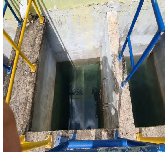
imagen14. Proceso de filtración PTAP de 90 Ips
