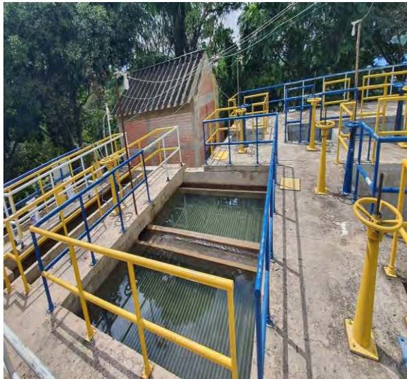
imagen11. Vista general sedimentador Q=45 lps
