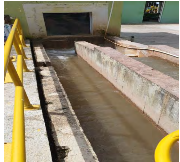
Canal repartidor agua a flocladores imagen8. Canal repartidor a floclador.
