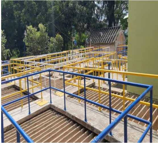
imagen9.Floculadores flujo horizontal Q=25 lps
