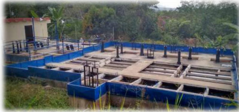
Figura 5. Planta de tratamiento de agua potable municipio de Manaure Balcón del cesar
