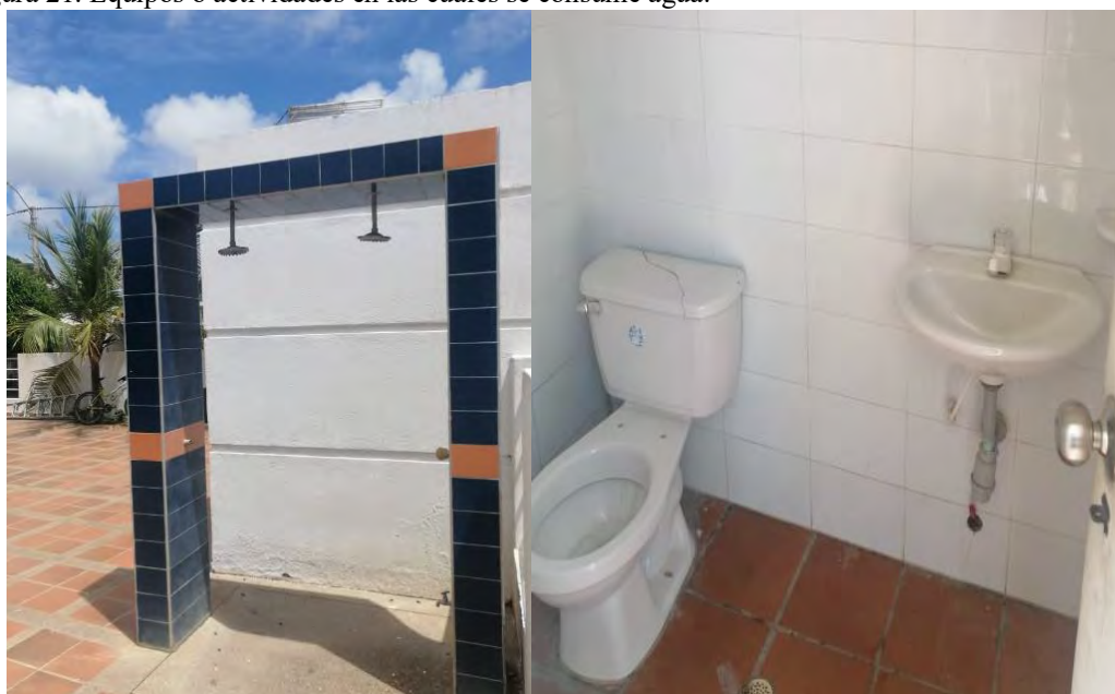
Figura 21. Equipos o actividades en las cuales se consume agua.
