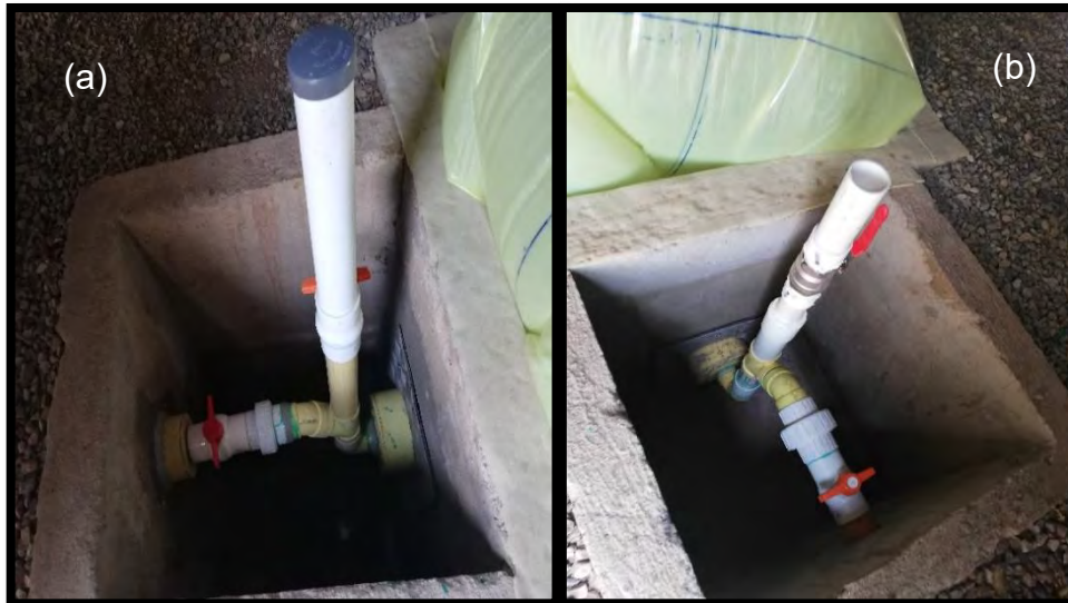
Imagen 57. Sistema de entrada y salida al biodigestor Fuentes: Autores
