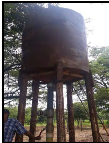
Imagen 8. Tanque de reservorio de agua de la finca La Arcadia Fuente: Autores
