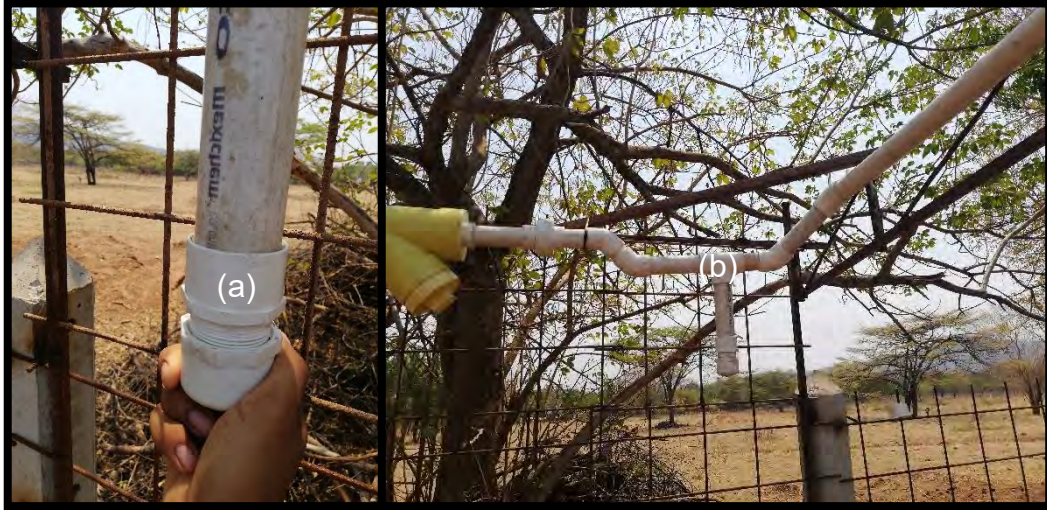
Imagen 46. Trampa de agua.. Fuente: Autores
