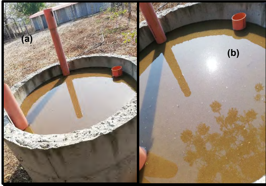
Imagen 56. Tanque de distribución. Fuente. Autores
