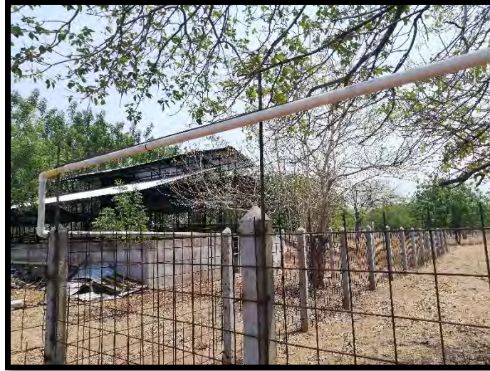
Imagen 48. Conducción del gas. Fuente: Autores
