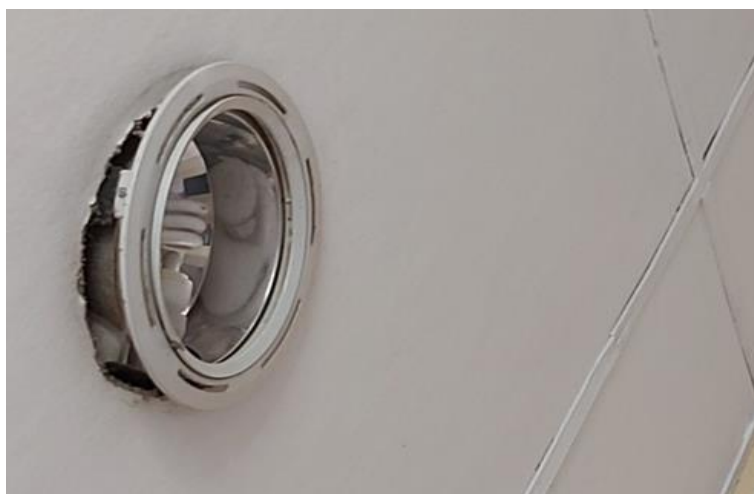
Figura 14. Pantalla de luz deteriorada
