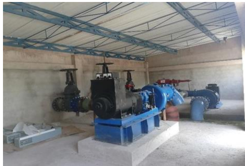
Foto 5. Turbinas generadoras de energía 45kw y Mezcla rapida
