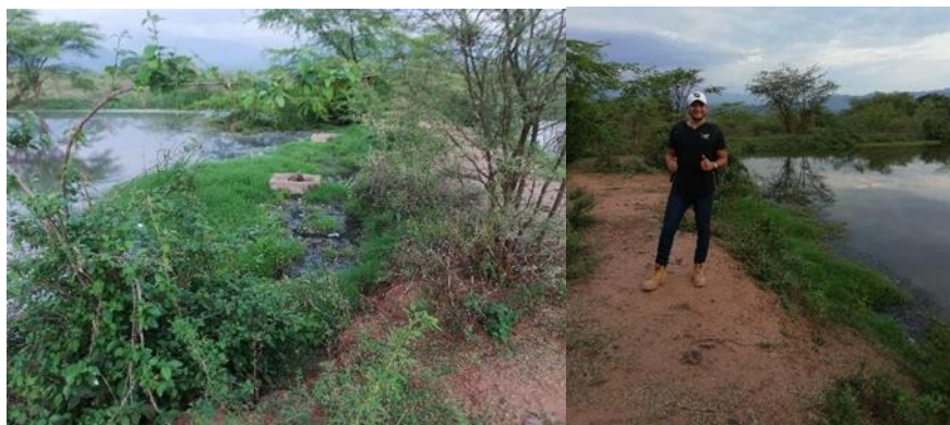
Foto 47. Sistema de tratamiento de aguas Residuales
