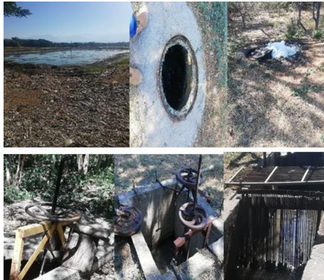
Foto 19. Algunos modulos y estructuras en mal funcionamiento
