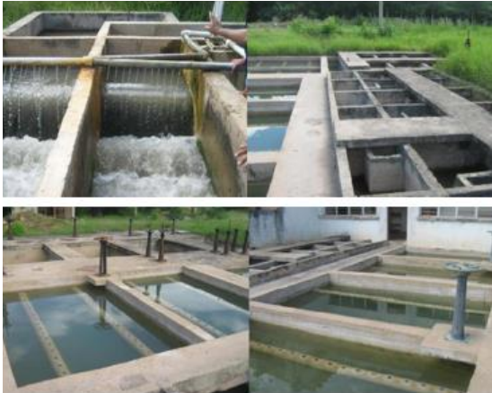
Foto 21. Planta de tratamiento de agua potable de la PAZ
