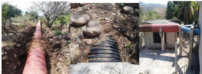
Foto 3. Redes de entrada de agua a la PTAP
