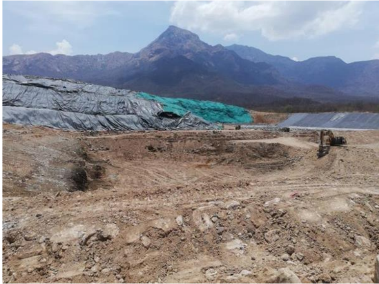
Foto 49. Relleno sanitario los corazones
