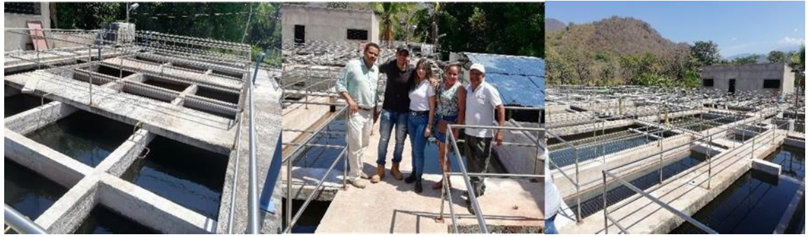
Foto 4. Planta de tratamiento de agua potable Codazzi
