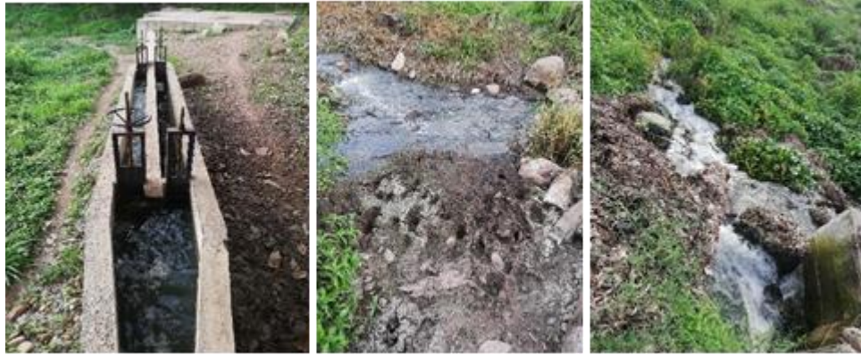
Foto 34. Canaletas de desvío de aguas residuales y vertimiento a los potreros
