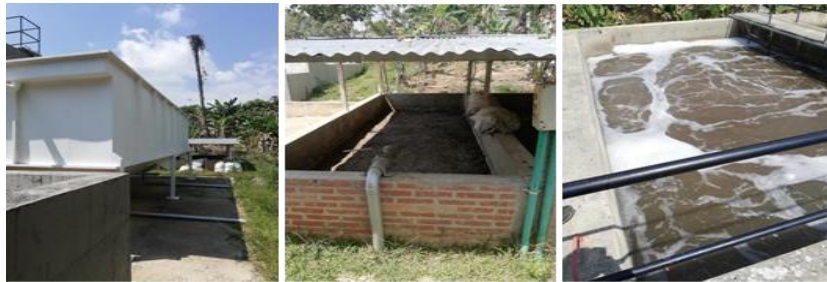
Foto 43. Secado de lodos, Reactor y sedimentador
