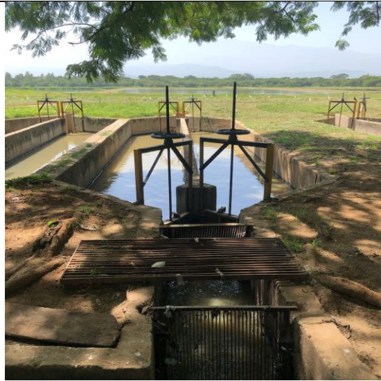
Figura 11. Desarenador (Fase I)
