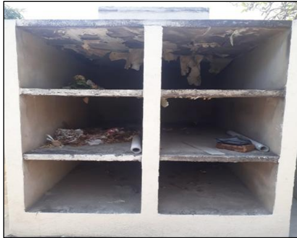
Fotografía 2. Bóvedas en mal estado Fuente: Autora, 2018
