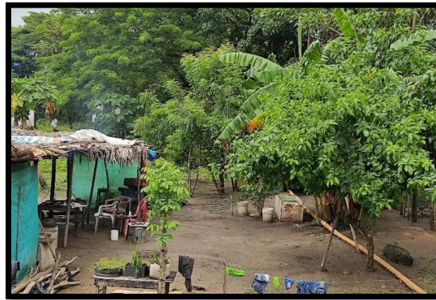
FIGURA 26 Tubería principal atravesando uno de los patios de las casas aledañas al sitio.
