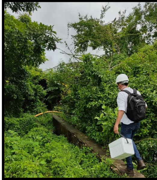
Tubería de Descarga Proveniente del Tanque de Almacenamiento
