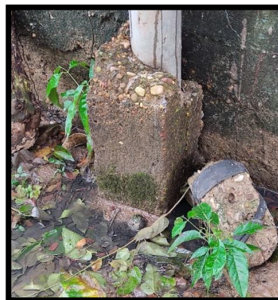
FIGURA 27 Fugas en la tubería principal por el mal estado en el que se encuentra.
