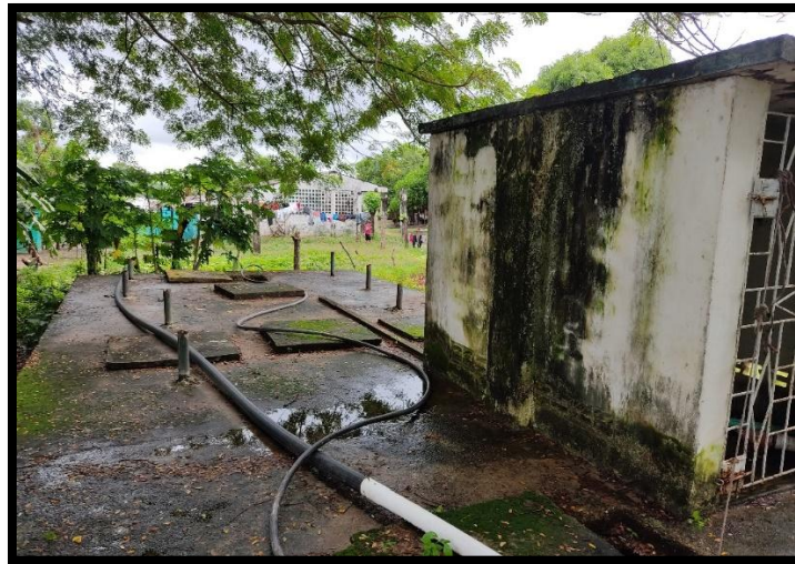
FIGURA 9 Tanque de Almacenamiento
