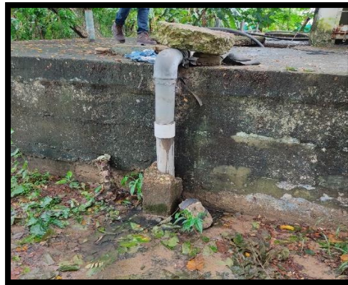
FIGURA 11 Tubería en Mal Estado del Tanque de Almacenamiento
