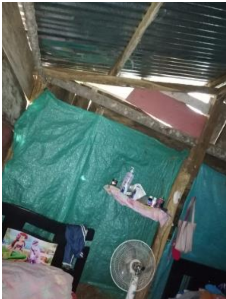
Figura 11. Estado de viviendas
