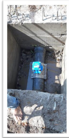
Ilustración 48 Ventosa línea de conducción Fuente: (Autores,2020)
