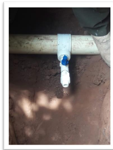
Ilustración 28 y 29 Válvulas utilizadas Fuente: (Autores,2020)
