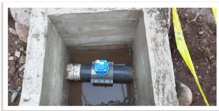
Ilustración 49 Ventosa línea de conducción Fuente: (Autores,2020)
