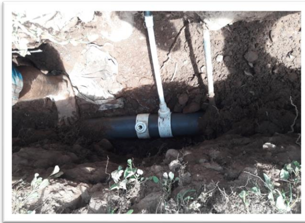
Ilustración 31 Apoyos de tuberías Fuente: (Autores,2020)
