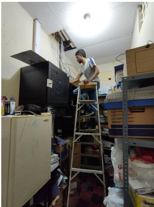
Figura 16. Revisión de cables de red LAN
