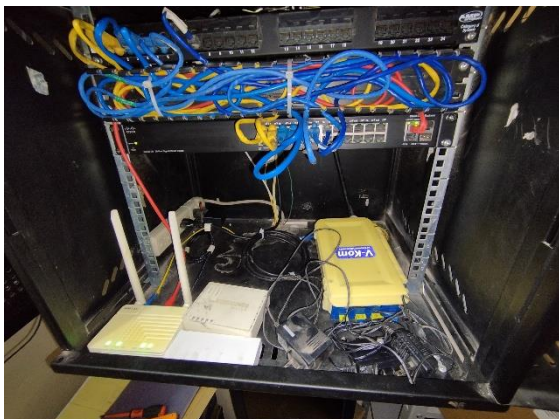
Figura 11. Rack en condiciones iniciales
