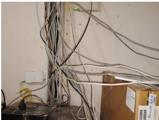
Figura 13. Cableado estructurado inicial
