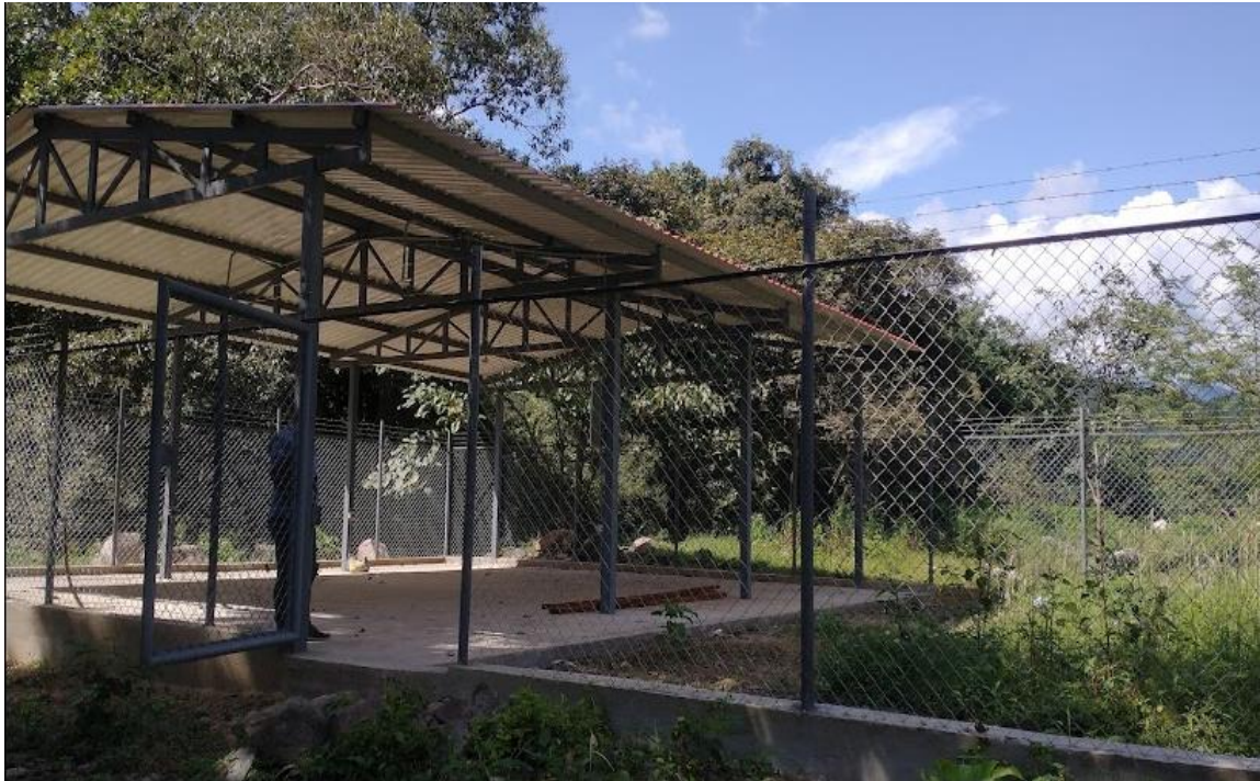
Figura 1 Imagen de infraestructura en etapa de adecuación Aprofruver
