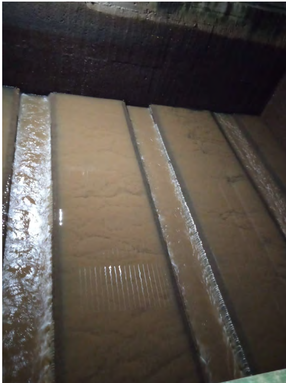
Unidad del proceso de filtración 2.
