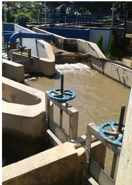
Canal de recolección de agua desarenada
