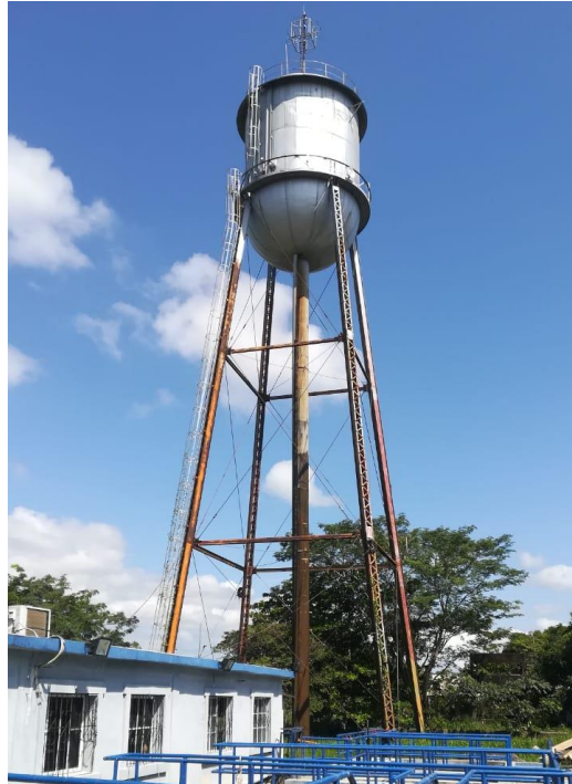
Tanque de almacenamiento elevado
