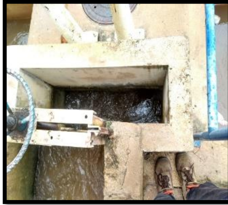
Ilustración 9 Floculador PTAP 1 . Fuente: (Autores,2020)
