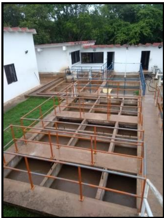
SISTEMA DE TRATAMIENTO DE AGUA POTABLE
