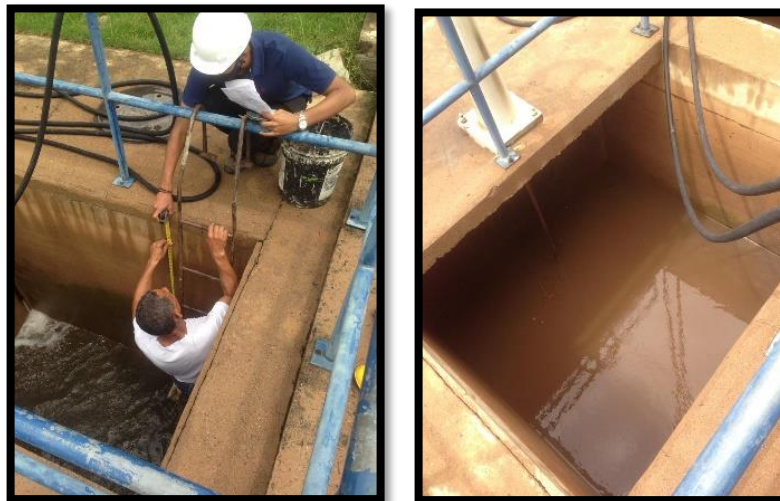
Ilustración 11 Proceso de Filtración PTAP 1 Fuente: (Autores,2020)
