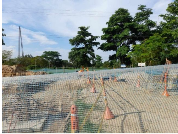
Figura 22. Ausencia de señalización.
