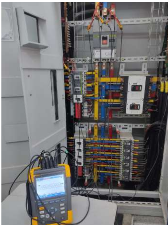
Figura 16. Tablero de la subestación 2
