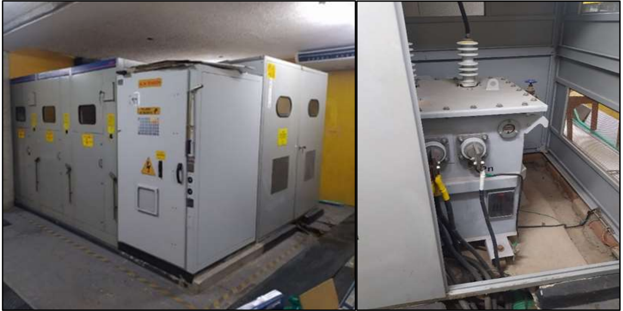
Figura 14. Subestación Eléctrica de media tensión encapsulada principal
