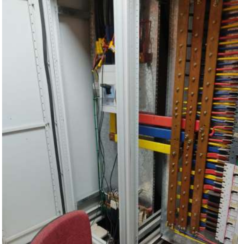
Figura 18. Tablero de la subestación 3.
