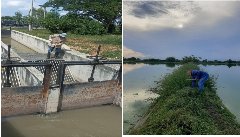
Figura 11. Labores de mantenimiento en la PTAR vía Puerto Mosquito y Lagunas de Oxidación de Jerusalén
