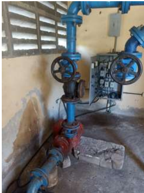
Figura 18 Estación de bombeo
