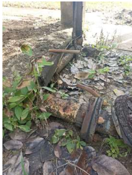
Figura 9 Tubería sanitaria añadida
