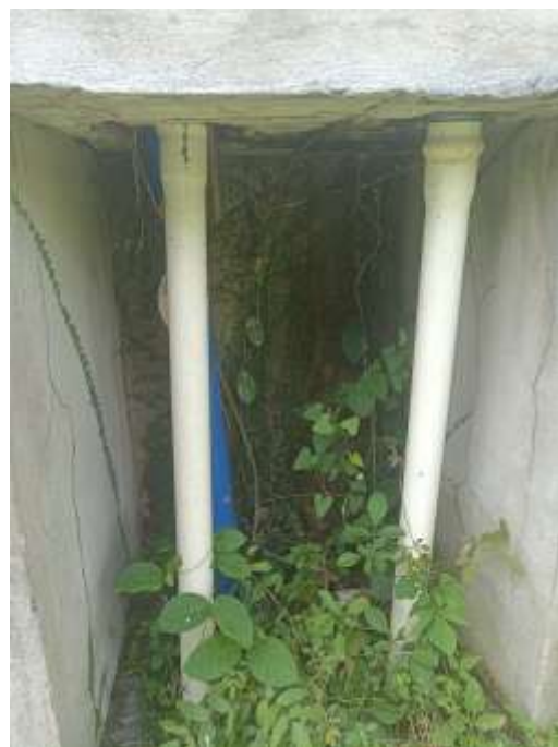
Figura 19 Tubería de llenado y descarga del tanque
