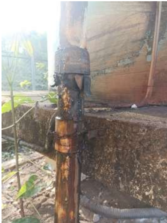
Figura 10 Tubería impulsión PTAP
