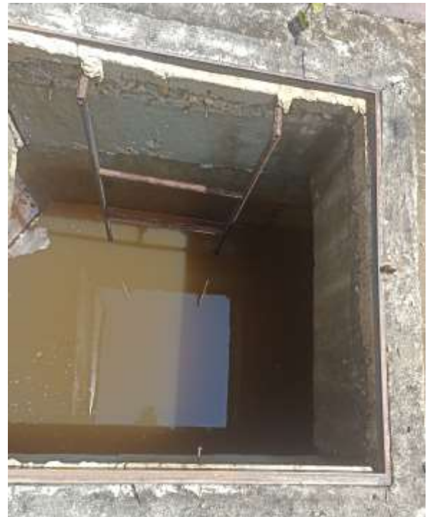
Figura 13 Tanque de almacenamiento La Victoria
