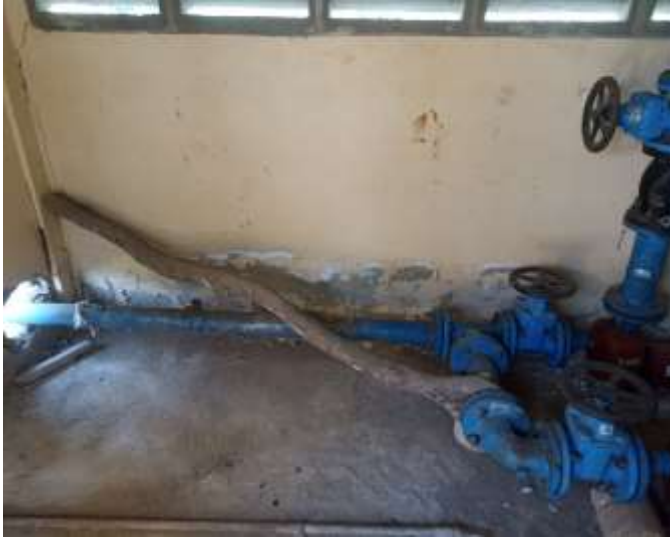
Figura 7 Caseta, tubería de aducción
