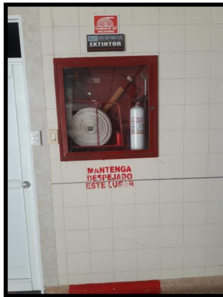
Ilustración 9 Gabinetes contra incendios
