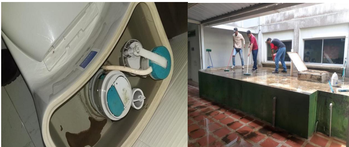
Figura 4. Pérdidas de agua
