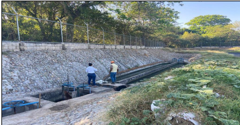
Figura 12 Sistema de tratamiento de Aguas residuales EMBECERRIL ESP
