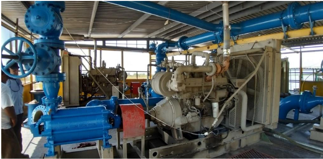
Figura 8: Motor de bombas de Captación
