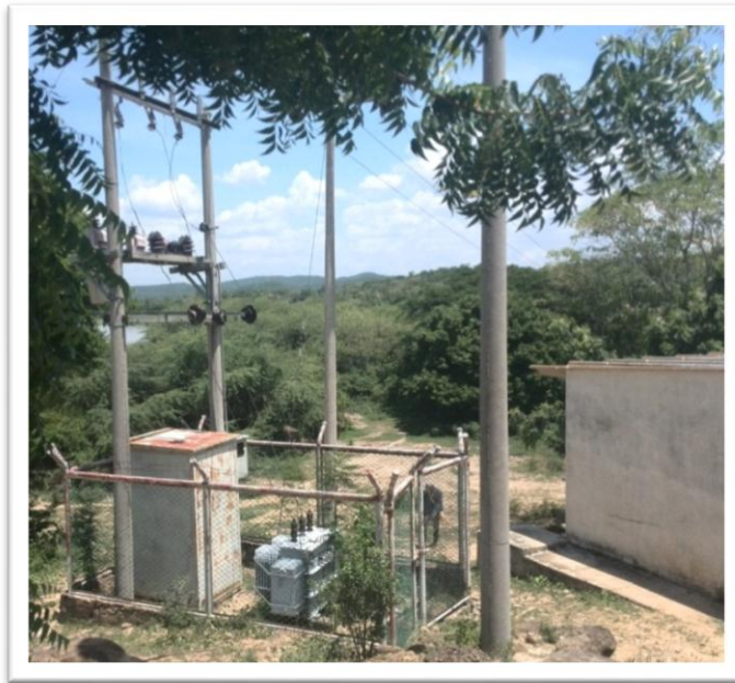
Figura 9: Subestación eléctrica en Estación bombeo No. 1
