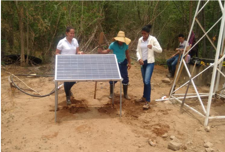
Disposición del módulo solar fotovoltaico.
