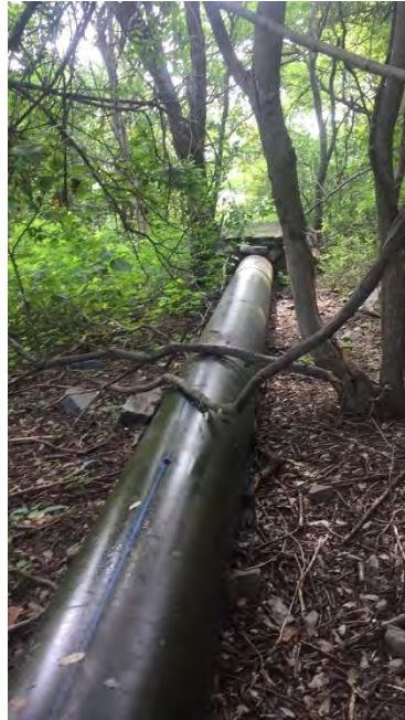
Figura 41. Tubería que abastece el tanque de almacenamiento de agua potable.
