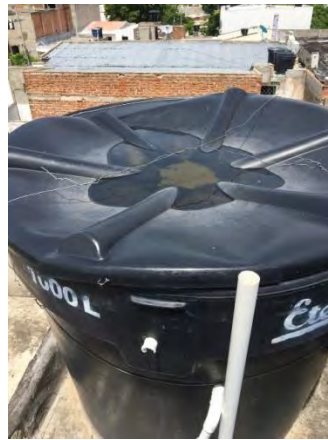
Figura 16. Tanque mal sellado, Casa 004.
