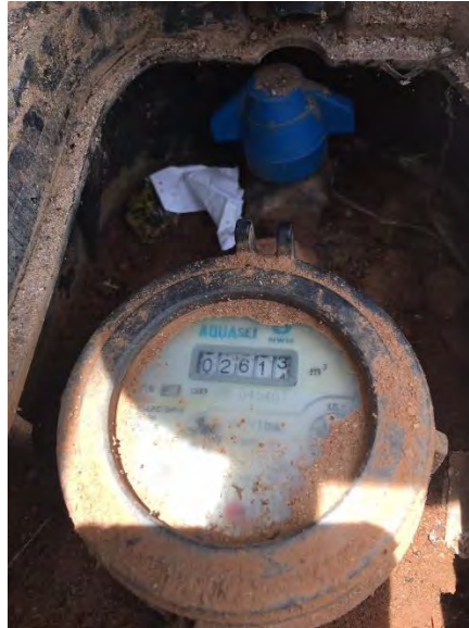
Figura 8. Cierre de la válvula del contador.
