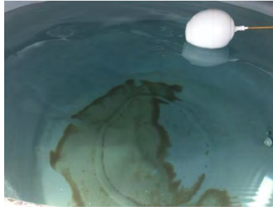
Figura 15. Manchas en el fondo del tanque, Casa 003.
