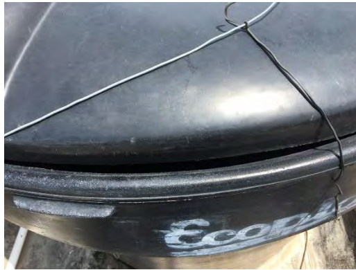
Figura 18. Tanque mal sellado, Casa 005.
