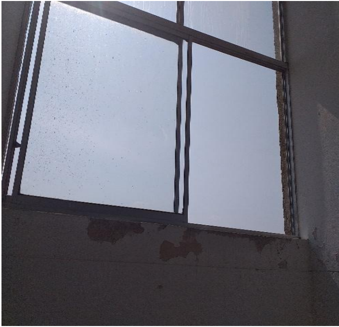
Paredes en mal estado (ventana segundo piso).
