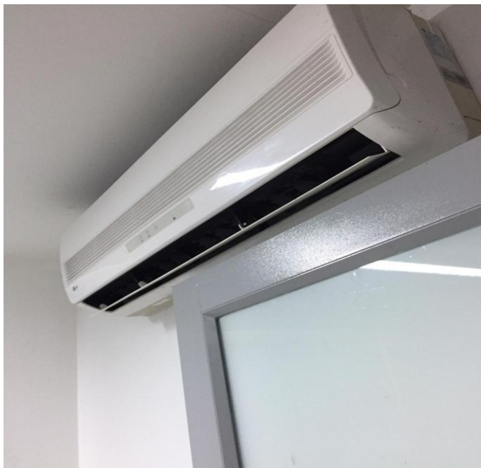
Aires acondicionados utilizados en las oficinas.
