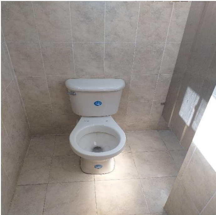
Cabina de baño sin recipiente para residuos sólidos.
