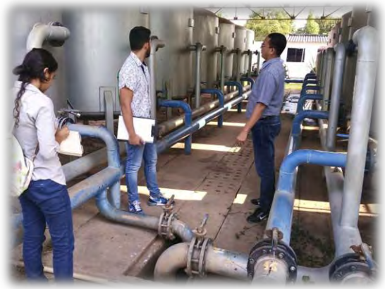
Imagen 22. Floculadores y Filtros Descendentes Compactos
