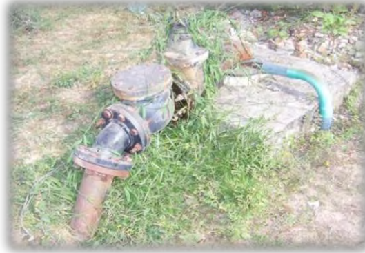
Imagen 25. Pozo La Zanjita
