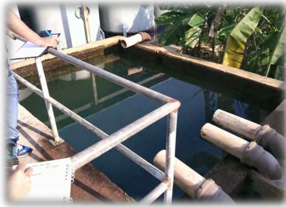
Imagen 23. Entrada del Agua Cruda de los Pozos
