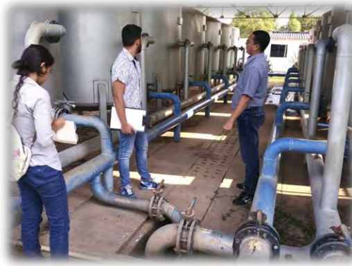
Imagen 5. Registro Fotográfico PTAP Chiriguaná Fuente: Autores, 2019.
