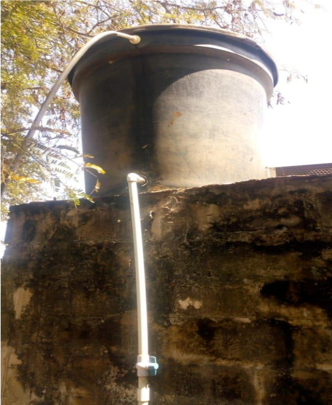
Figura 27. Tanque Almacenamiento del sistema presente en la zona.
