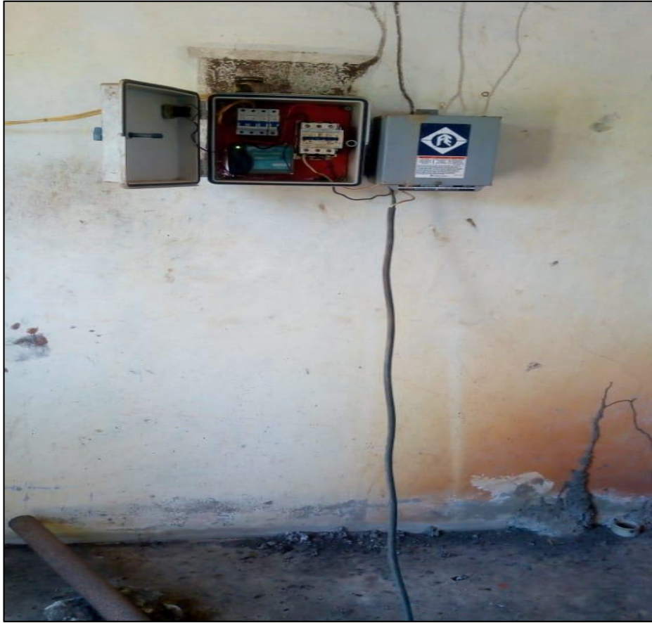
Figura 26. Interruptor de la bomba presente en la zona
