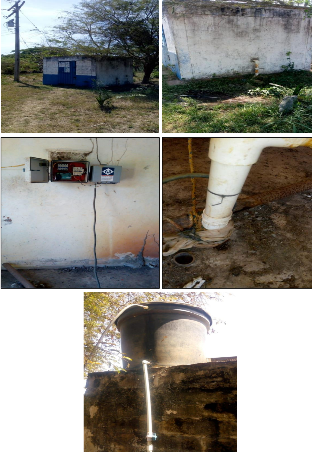
Figura 15. Componentes obra de captación presente en la zona
