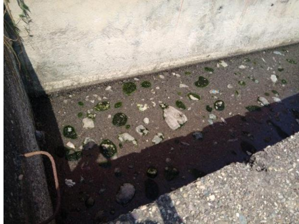
Figura 115 Unidades de la Planta de tratamiento de agua residual municipal en mal estado
