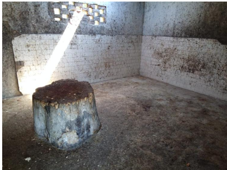
Figura 104 Deficiencias sanitarias en el matadero municipal, Chiriguana Cesar
