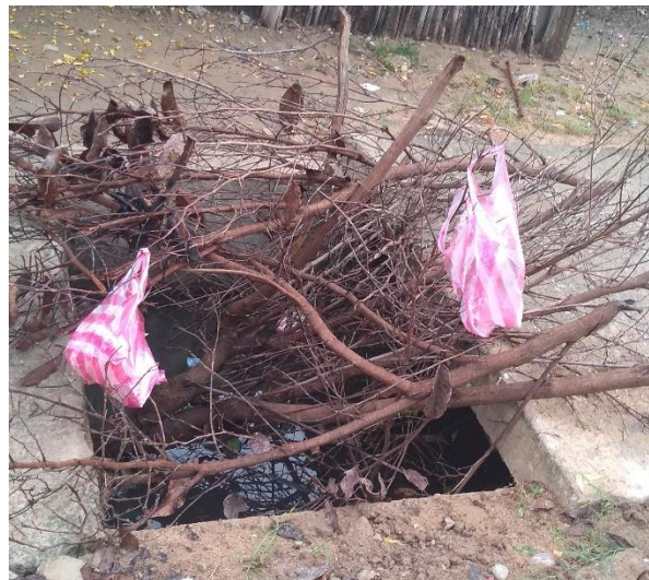
Figura 108 Redes de alcantarillado en mal estado, casco urbano de Chiriguana Cesar
