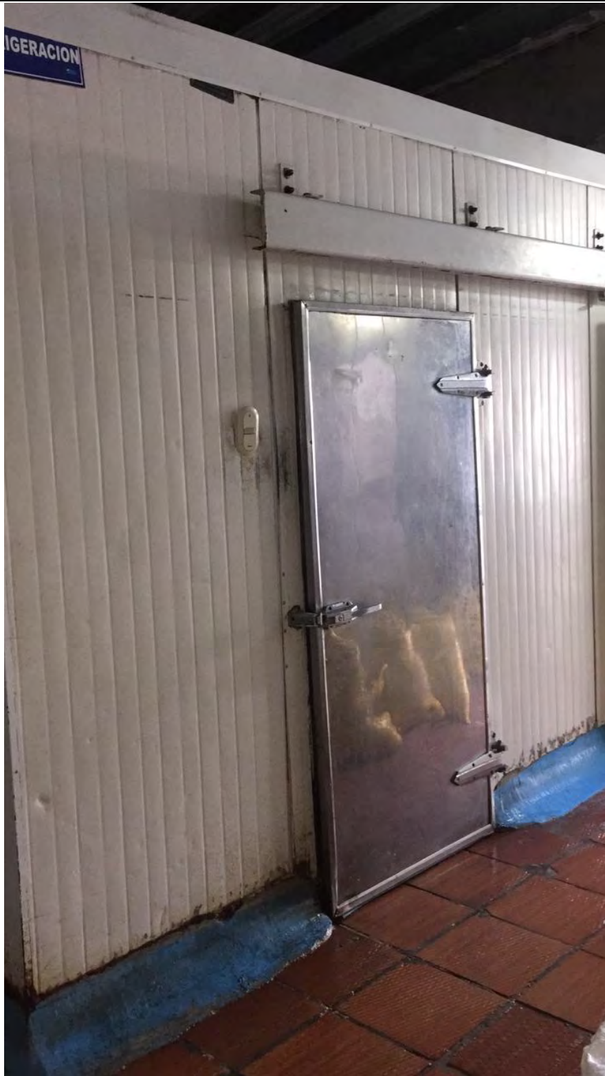
Figura 27. Cámara de Refrigeración de los Productos
