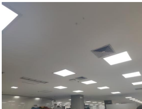
Iluminación tipo LED de las instalaciones y rejillas de ventilación de aire acondicionado.
