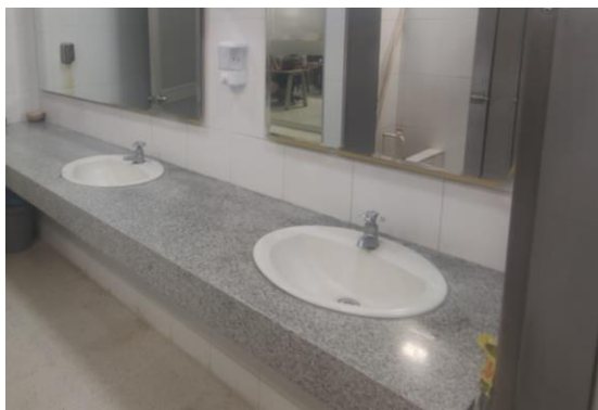
Lavamanos de baños para hombres.
