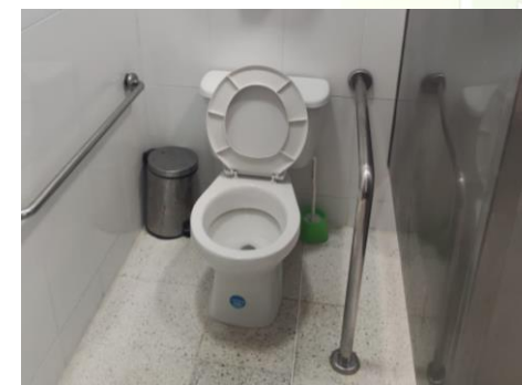
Sanitario de baños para hombres.
