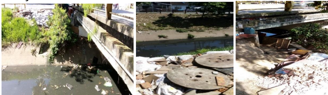
Figura 10: Manejo inadecuado de residuos solidos
