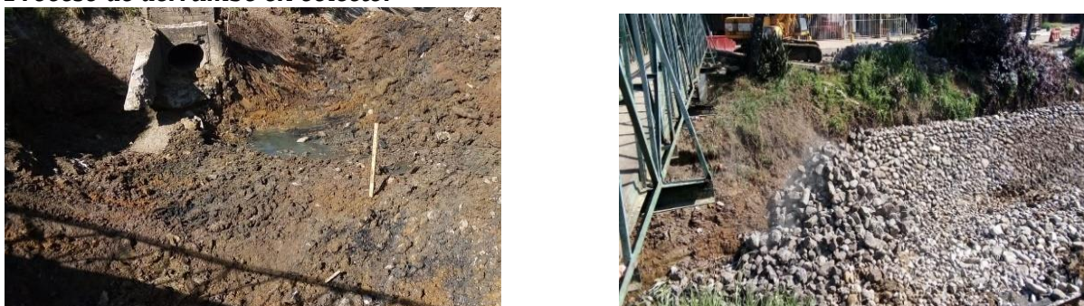
Figura 11: Proceso de derrumbe en colector
