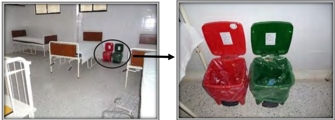
Ilustración 10.1. Evidencia de contenedores con sistema de cierre dañado
