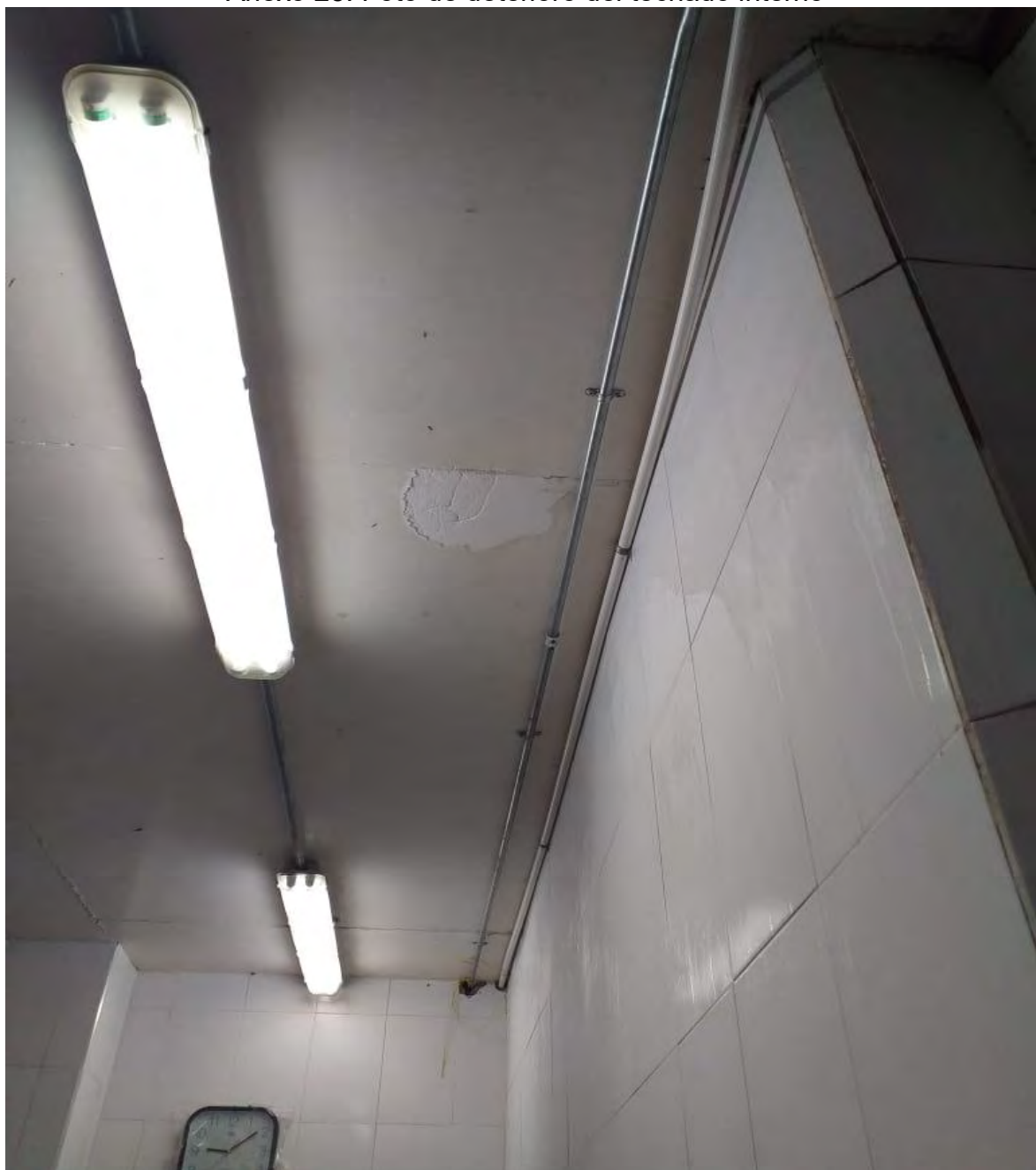
Anexo 25. Foto de deterioro del techado interno
