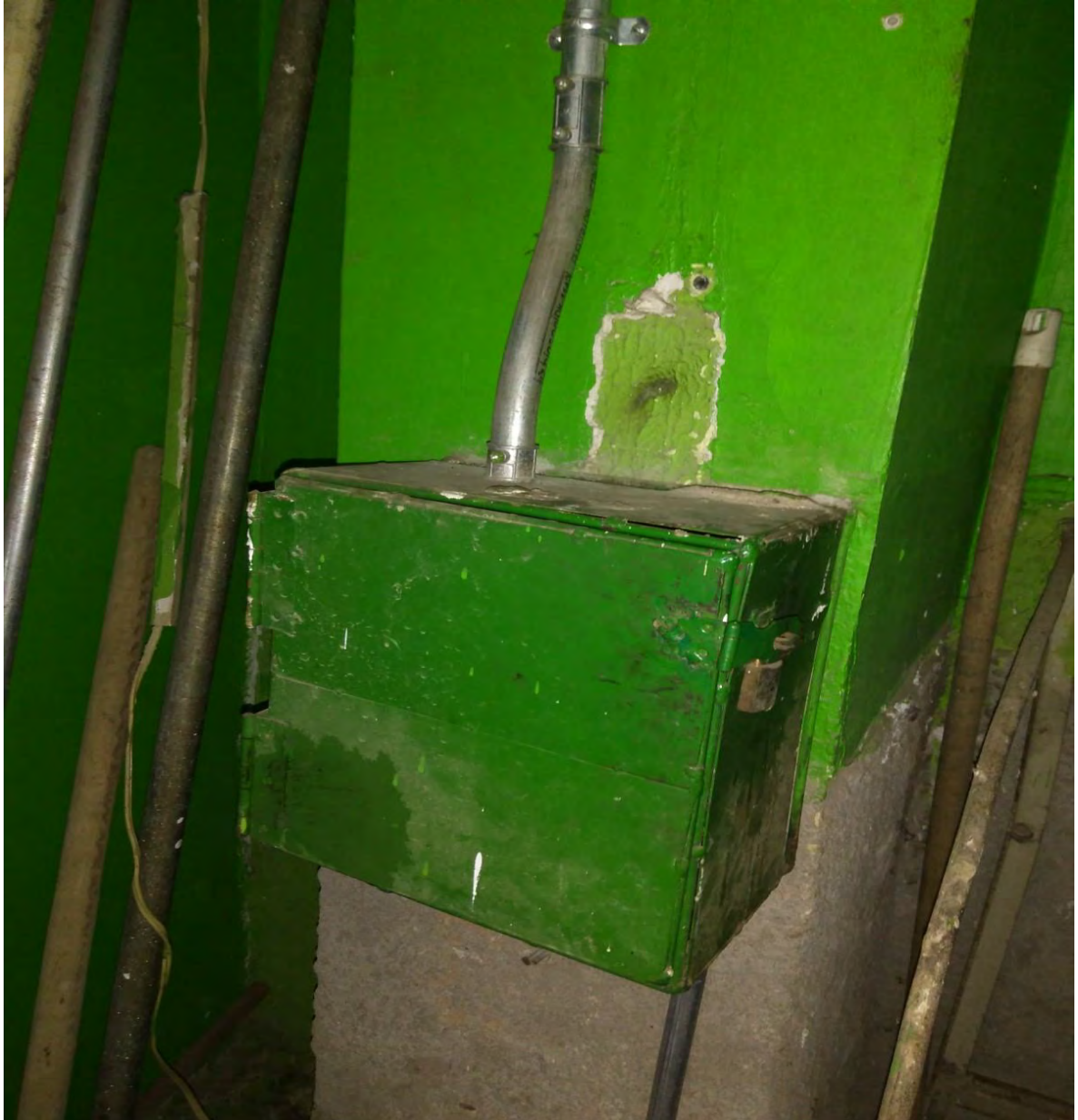
Anexo 12. Foto de deterioro de consola eléctrica
