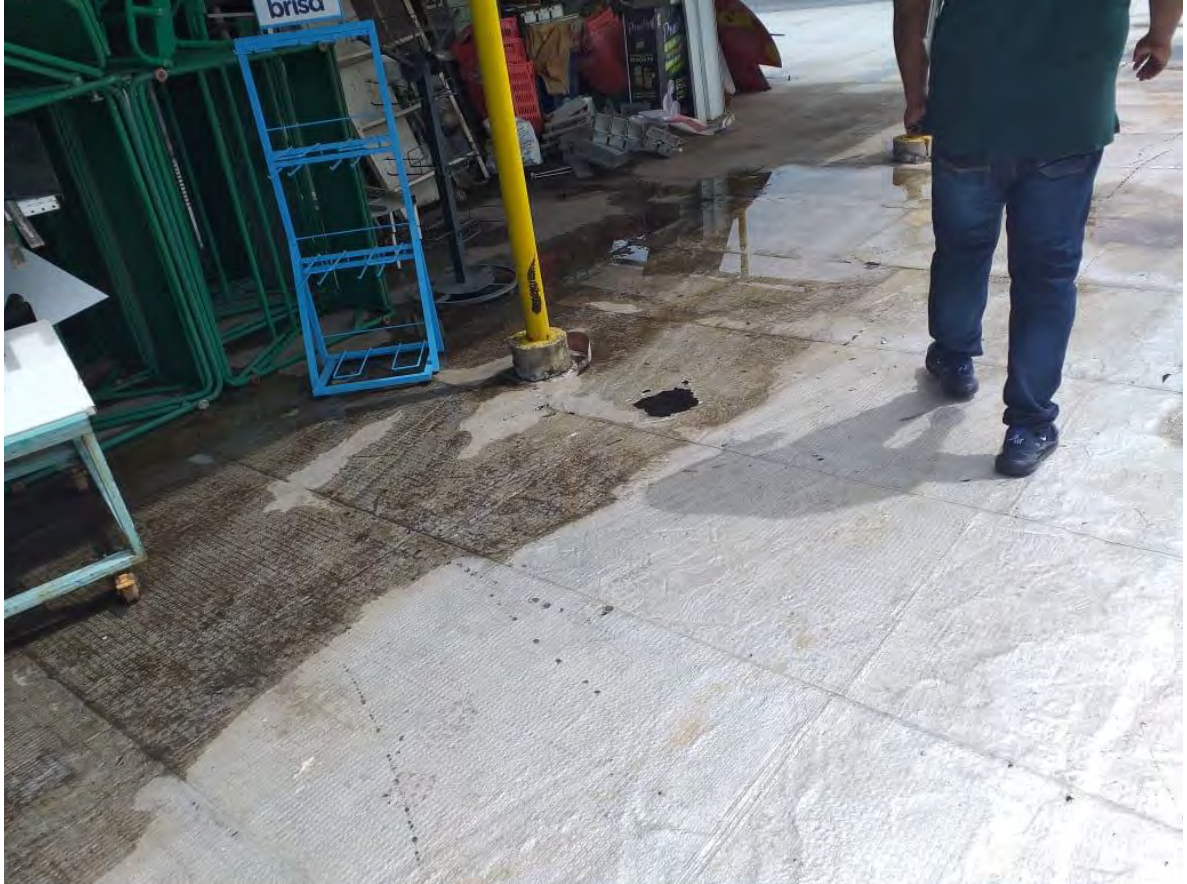
Anexo 21. Foto de filtraciones en espacios de trabajo
