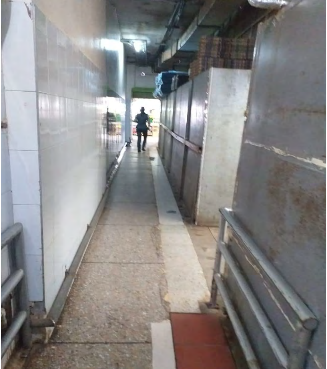
Anexo 46. Foto de deterioro de paredes y pisos
