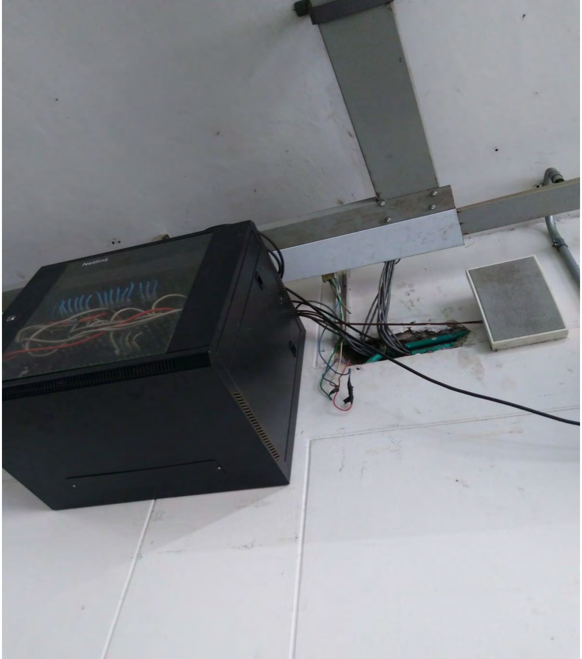
Anexo 10. Foto de cableado expuesto
