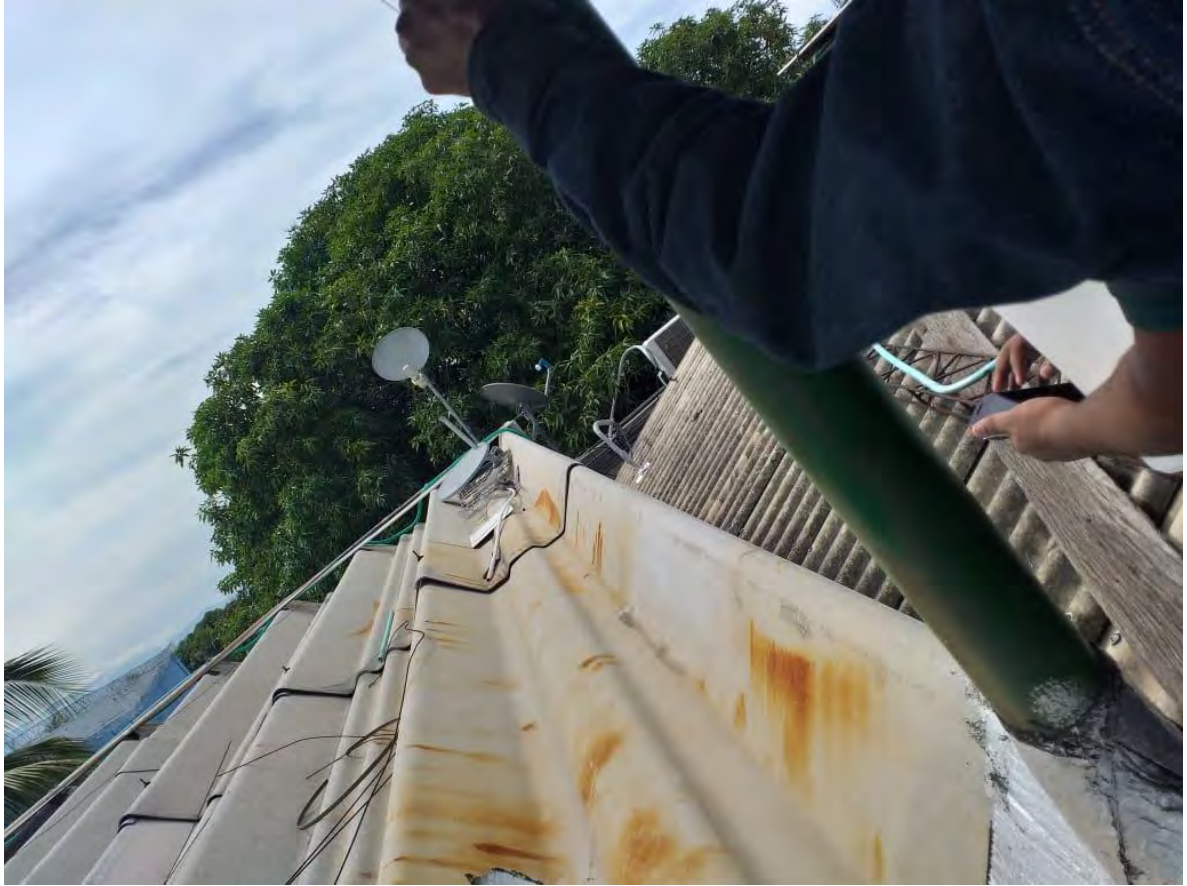
Anexo 15. Foto de deterioro del techado externo
