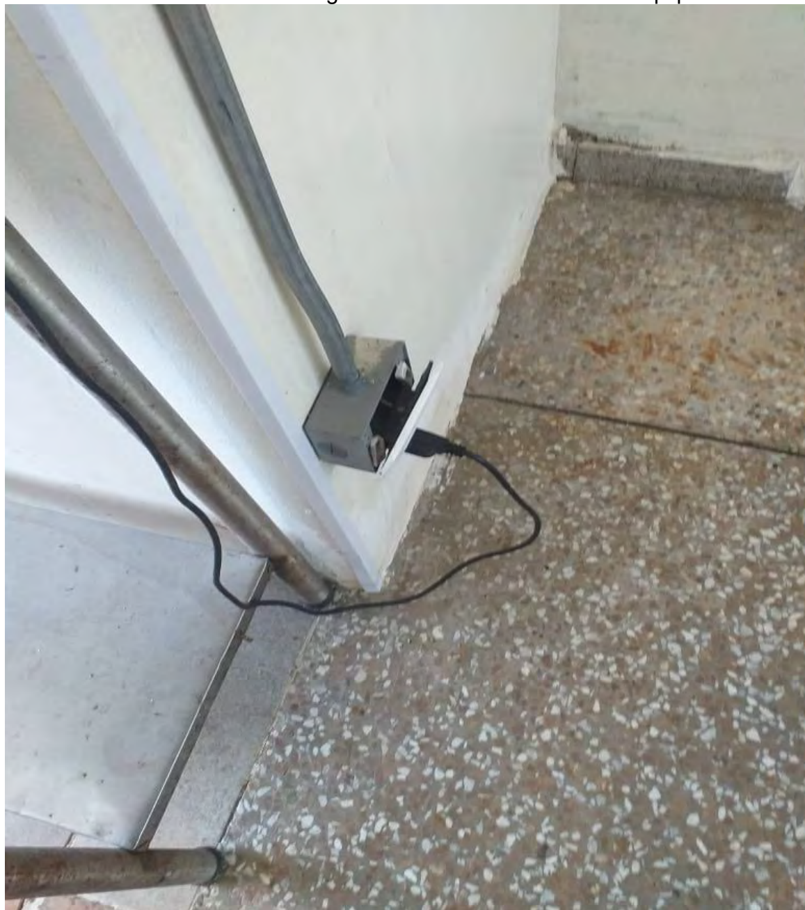
Anexo 41. Foto de riesgo de conectores eléctricos de equipos
