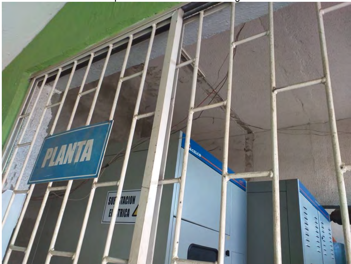
Anexo 13. Foto de exposición de cableado en los generadores eléctricos
