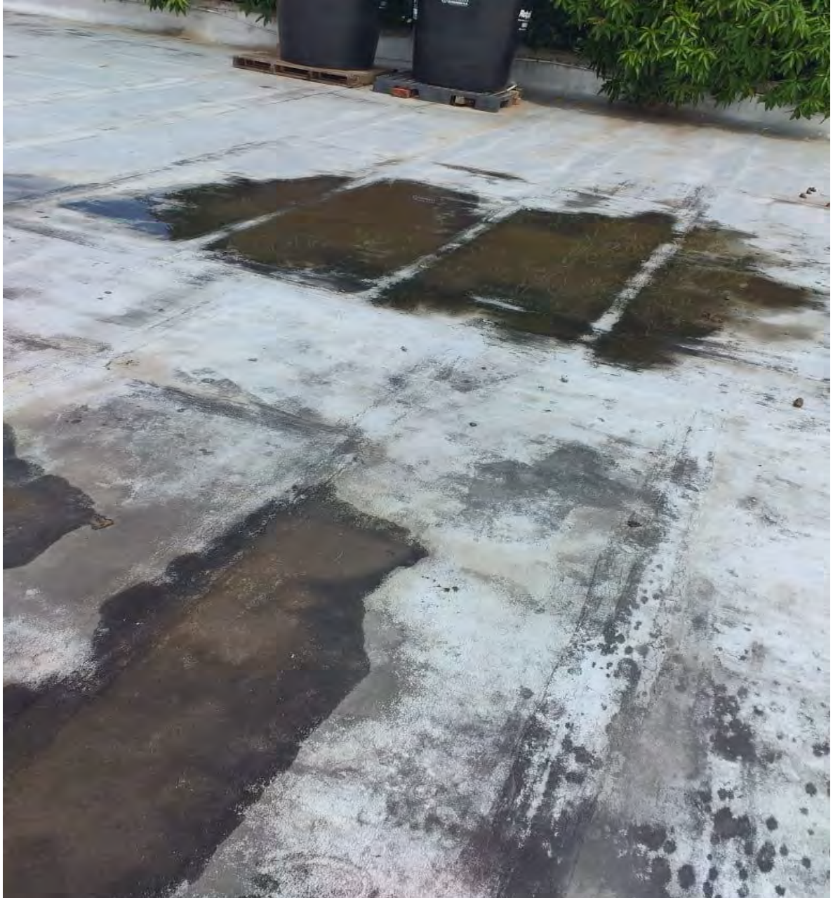
Anexo 18. Foto del deterioro del techado externo
