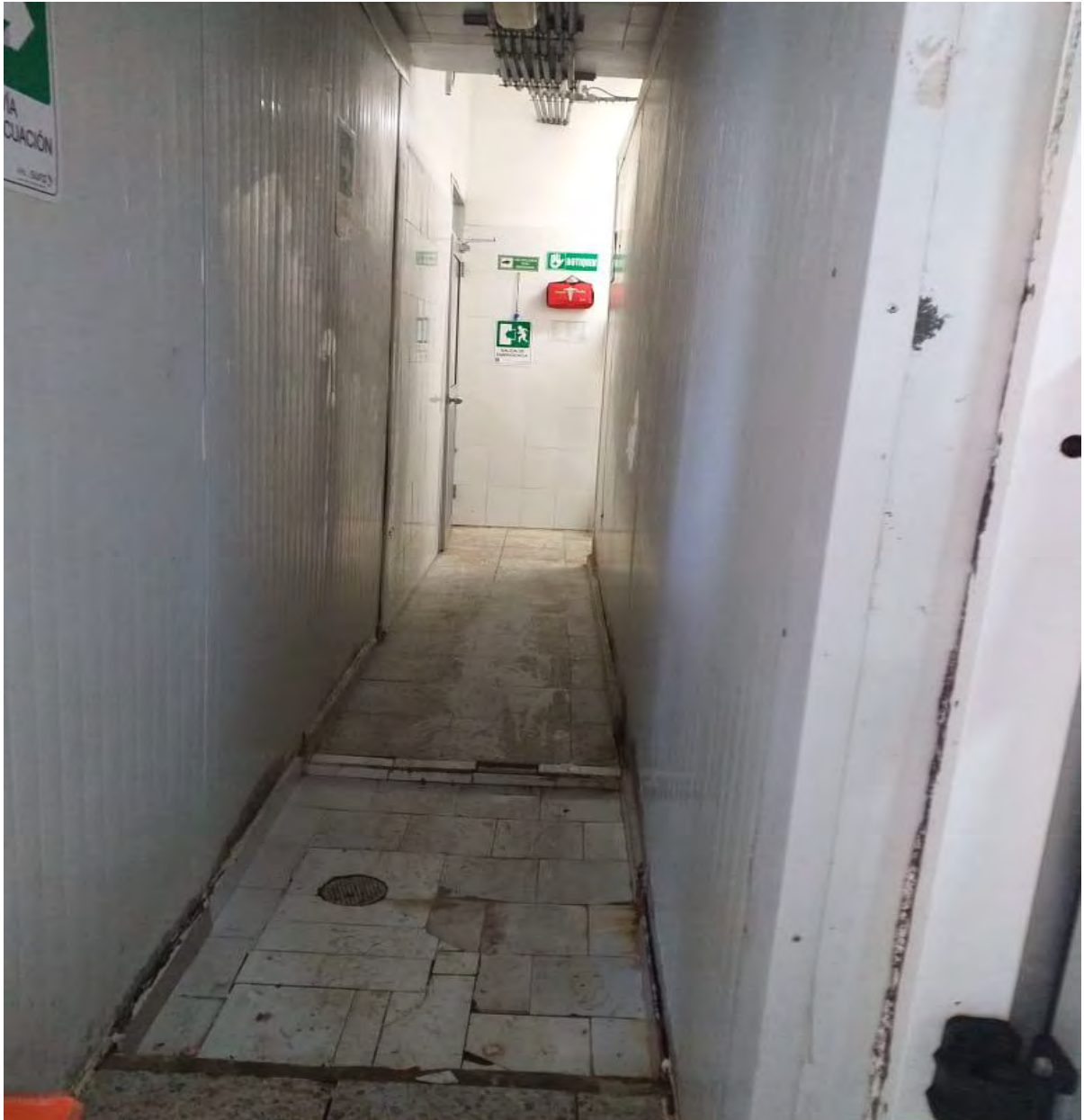
Anexo 47. Foto de deterioro de la salida de emergencia
