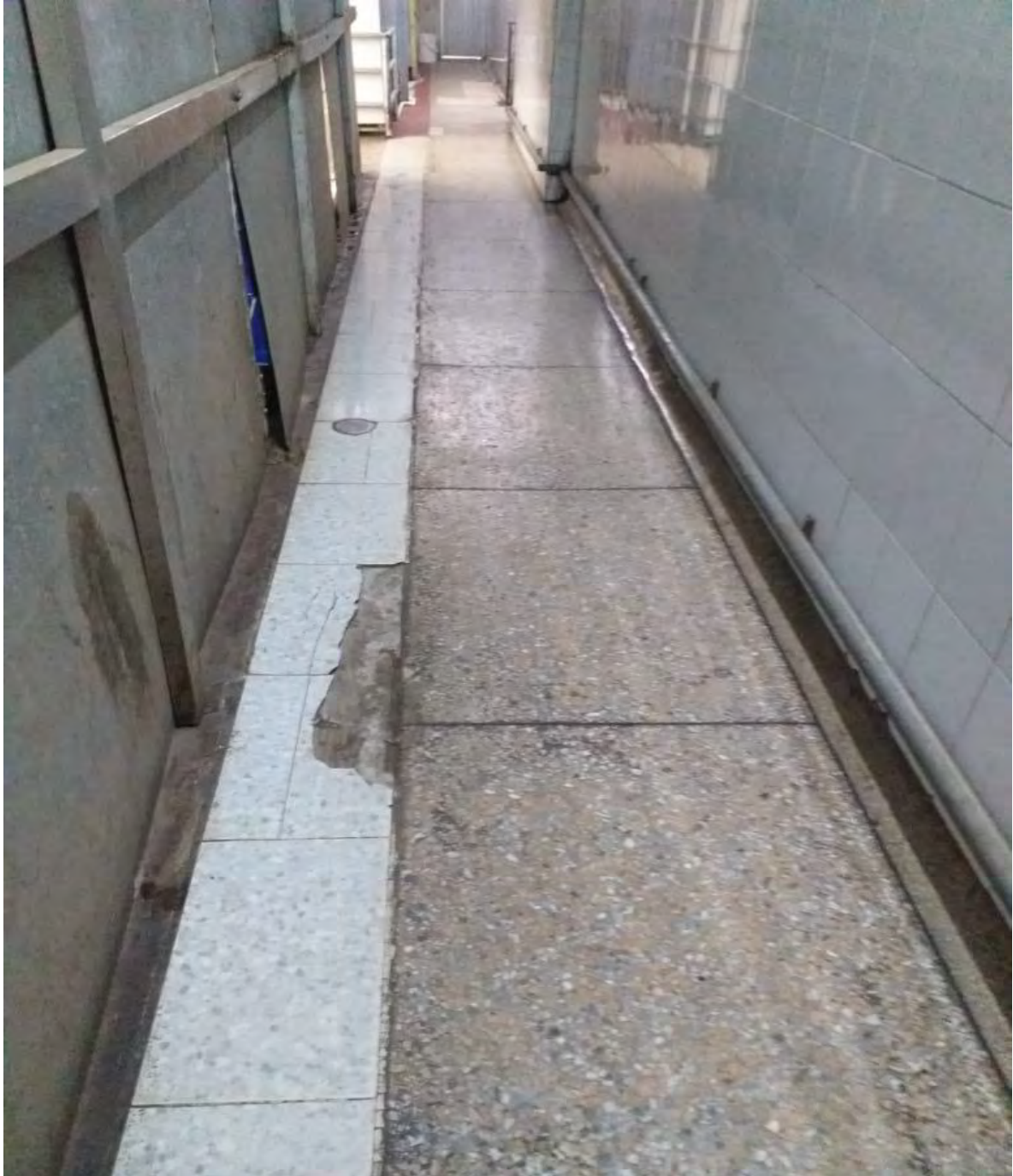
Anexo 14. Foto de deterioro de los pisos
