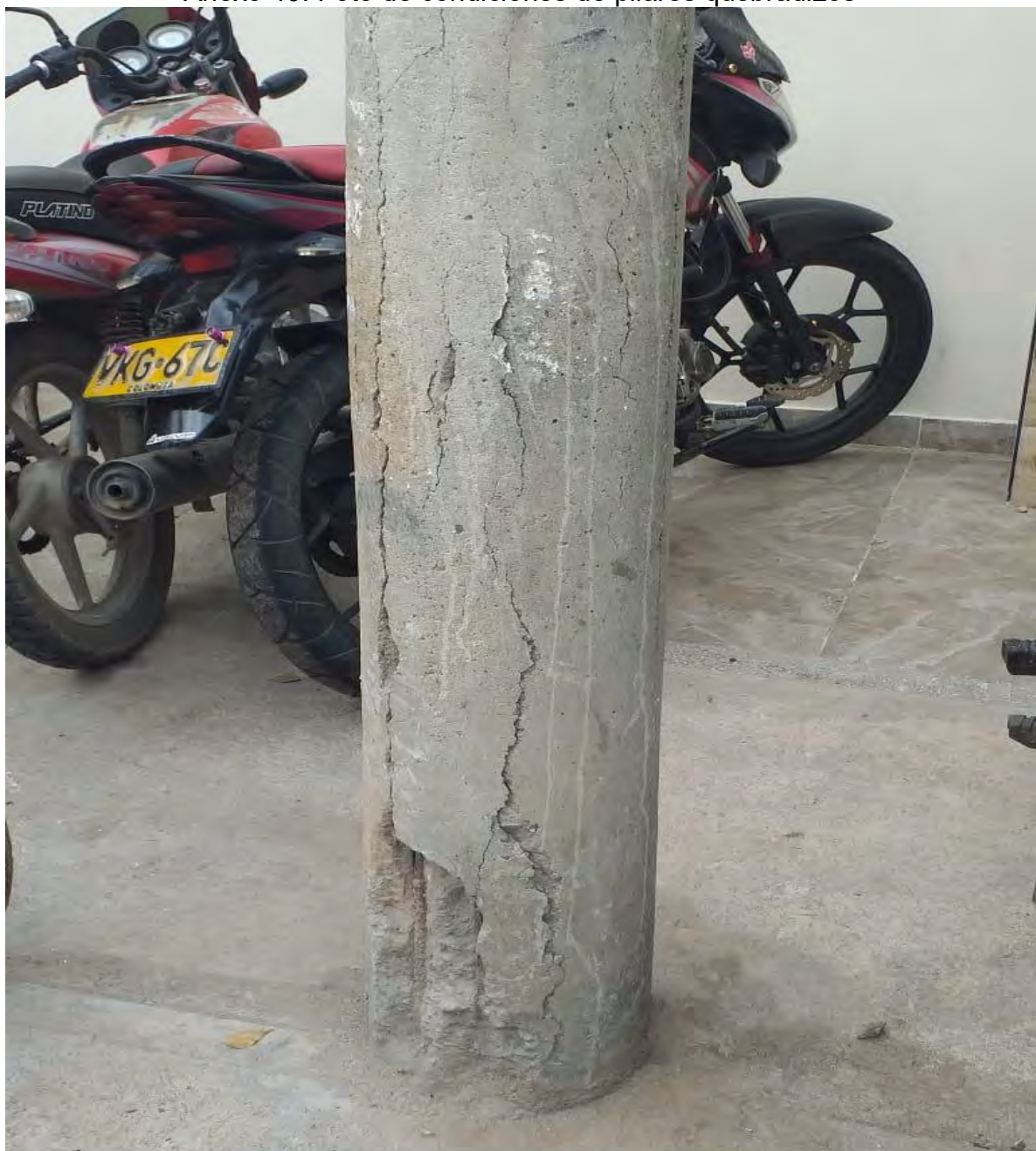
Anexo 40. Foto de condiciones de pilares quebradizos
