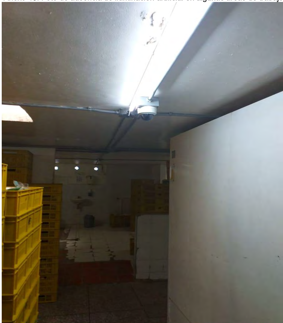
Anexo 43. Foto de ausencia de iluminación artificial en algunas áreas de trabajo
