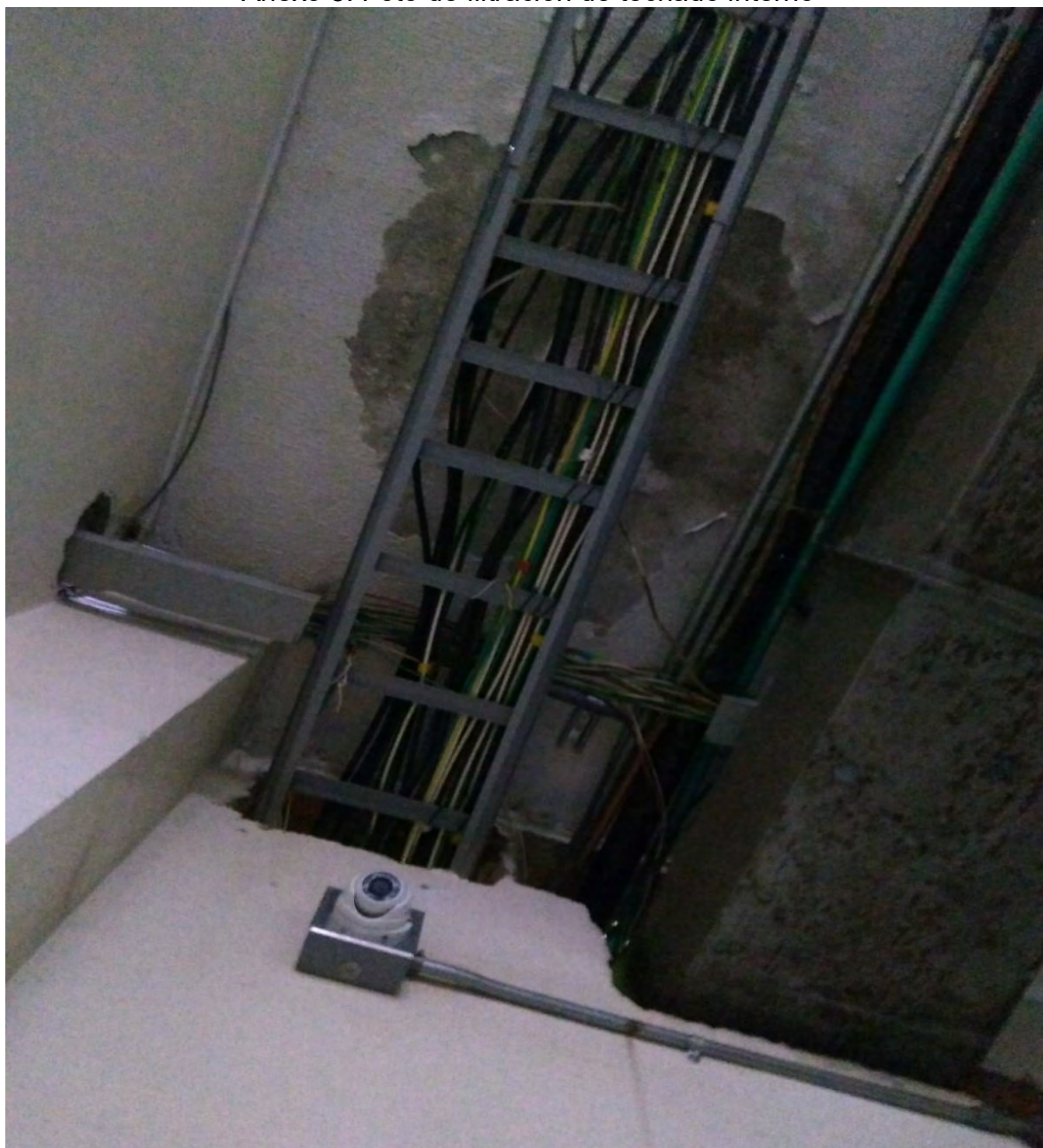
Anexo 8. Foto de filtración de techado interno
