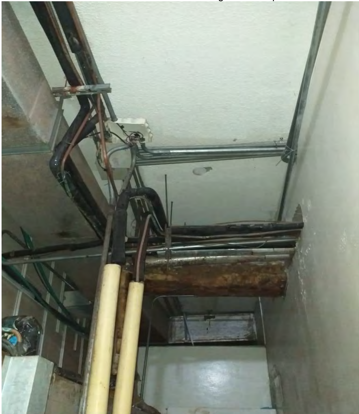
Anexo 45. Foto de ausencia de iluminación en lugares de inspección de tuberías
