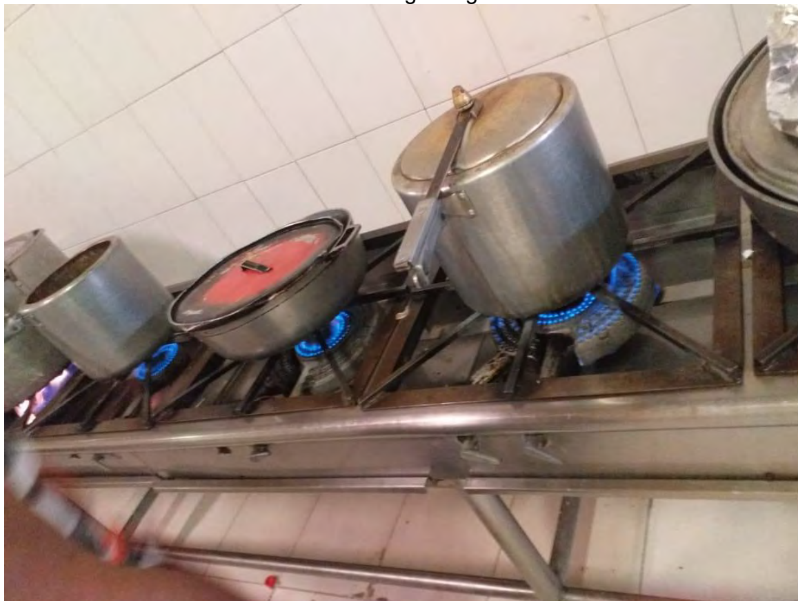
Anexo 37. Foto de fuga de gas inflamable
