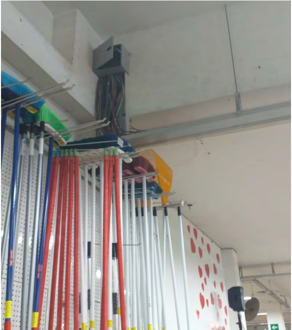
Anexo 29. Foto de exposición de cajas eléctricas
