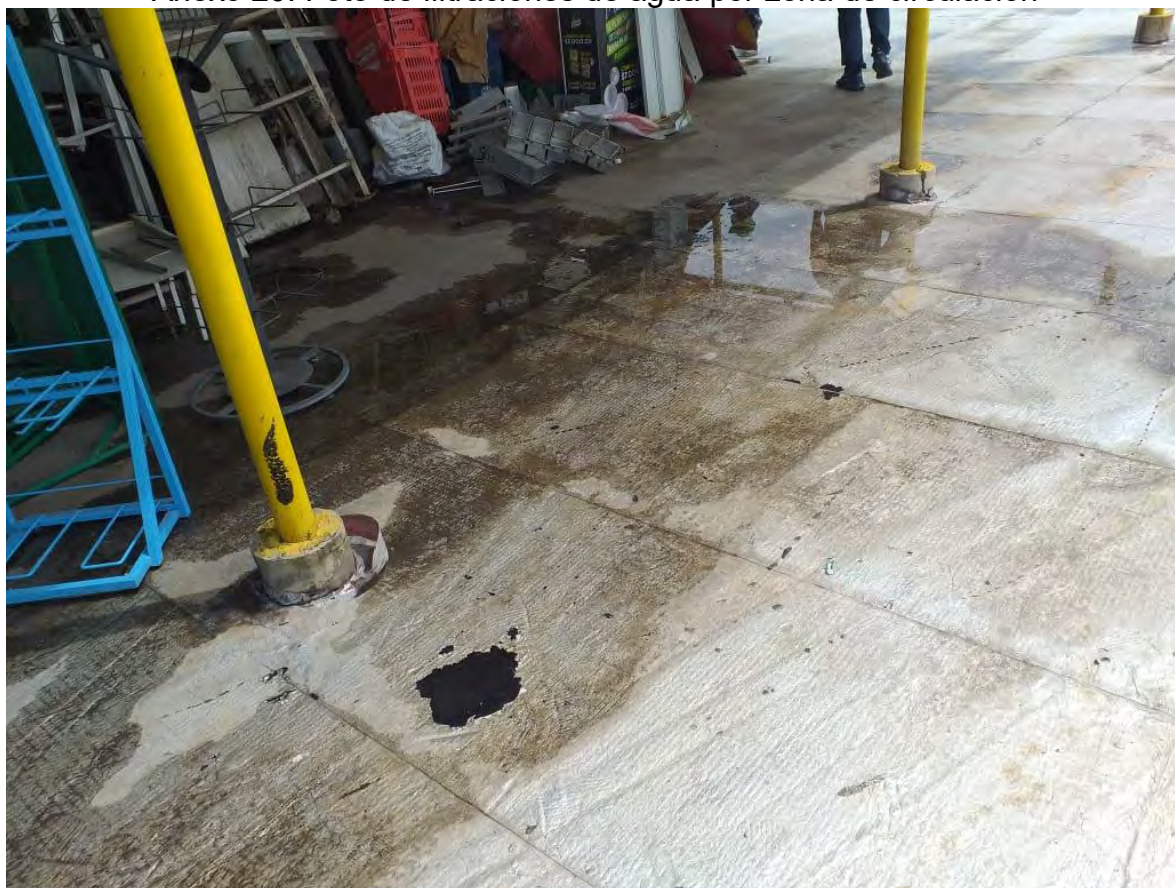
Anexo 20. Foto de filtraciones de agua por zona de circulación
