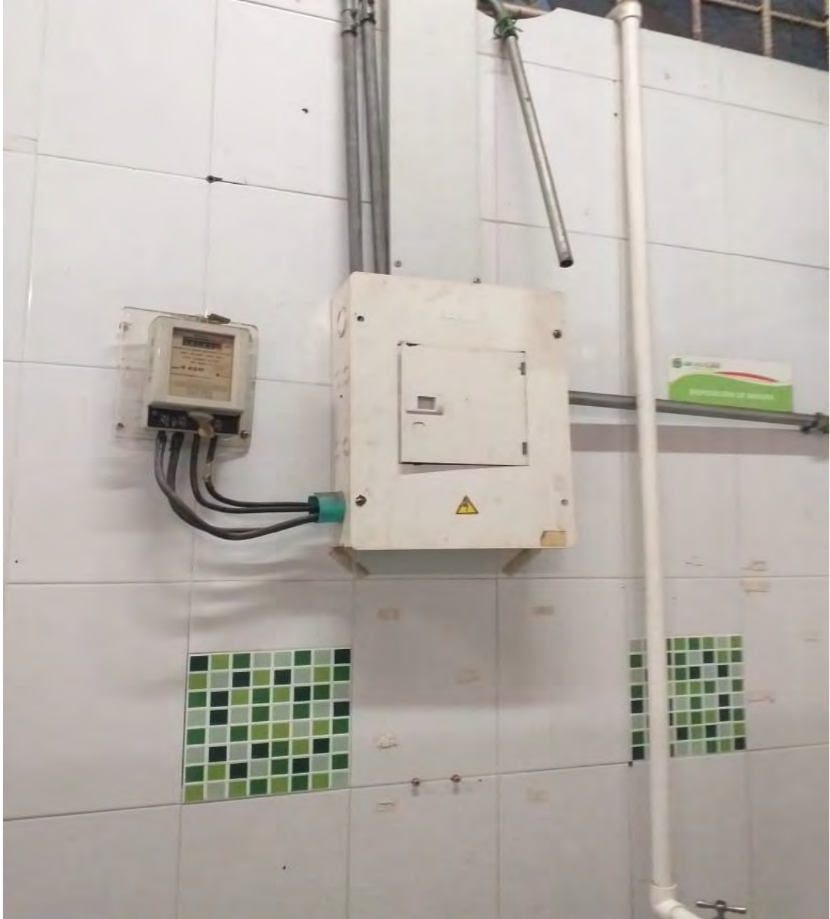
Anexo 23. Foto del deterioro y exposición de caja eléctrica
