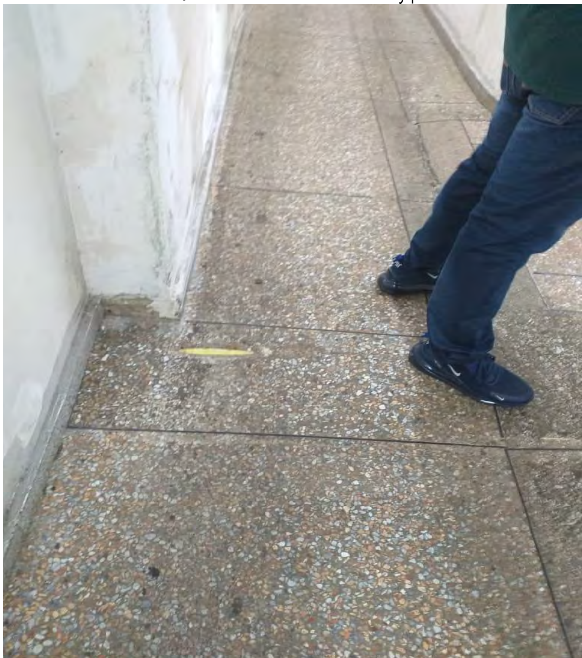
Anexo 26. Foto del deterioro de suelos y paredes
