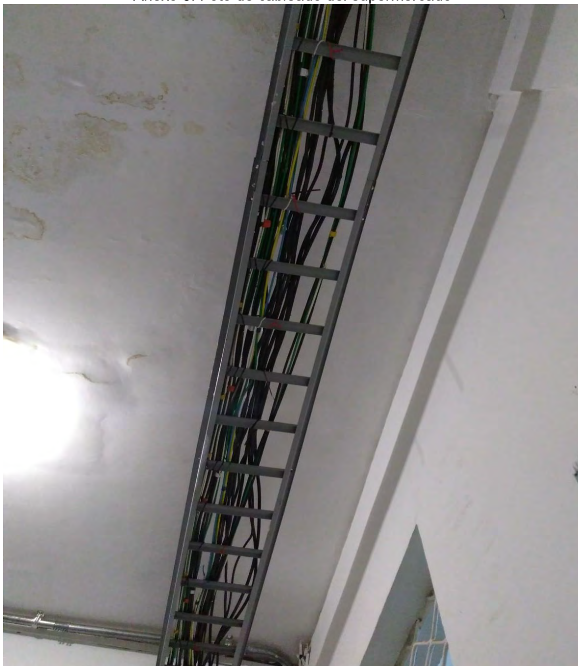
Anexo 6. Foto de cableado del supermercado
