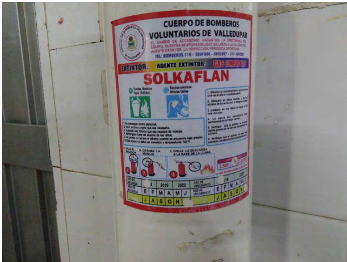
Anexo 31. Foto Presencia de alguno Extintores Internos
