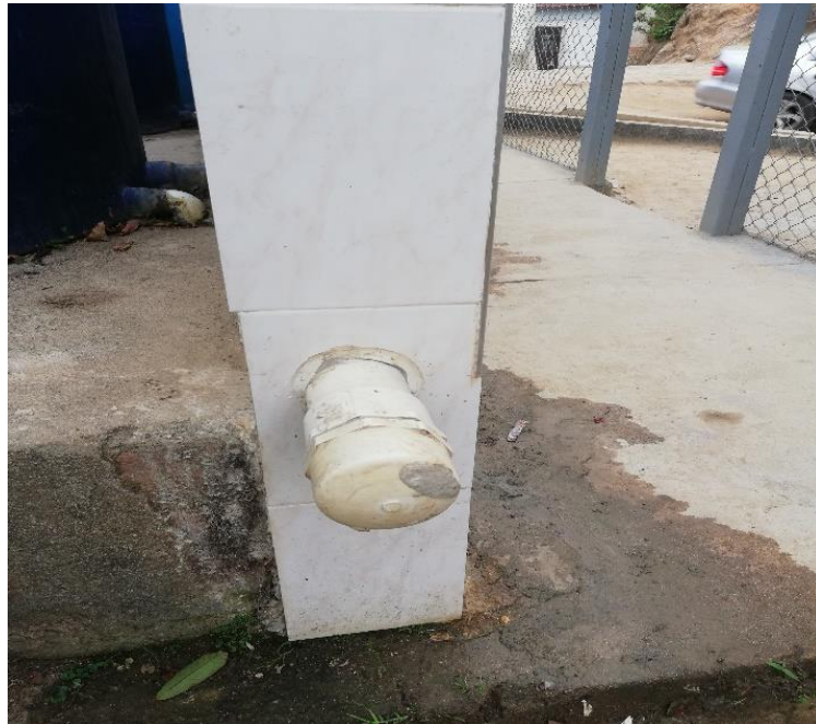
Figura 20. Tubería utilizada para el mantenimiento de los tanques Fuente. Autor, 2019
