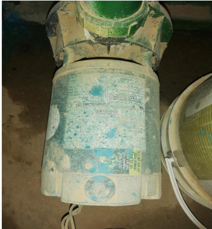
Figura 14. Electromotobomba Fuente. Autor, 2019
