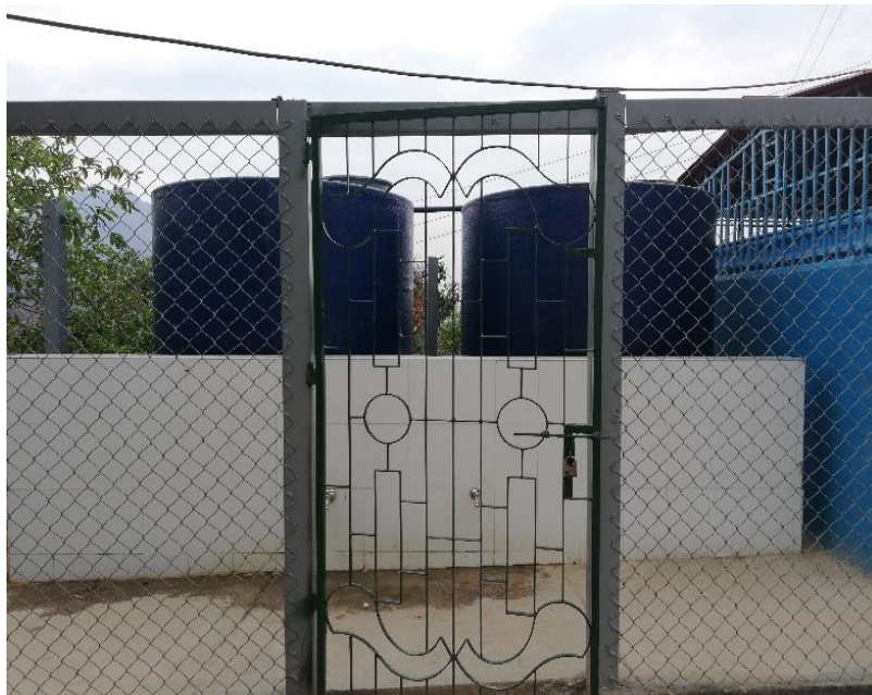
Figura 18. Tanques de almacenamiento. Fuente. Autor, 2019
