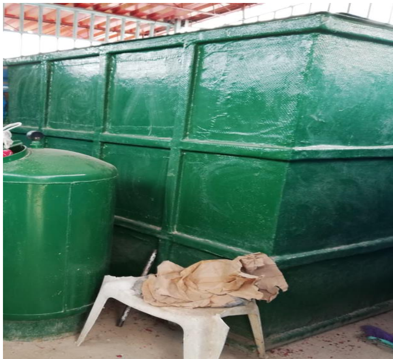
Figura 11. Exterior del sedimentador- floculador. Fuente. Autor, 2019
