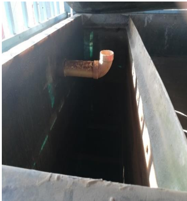
Figura 13. Tubería de rebose
