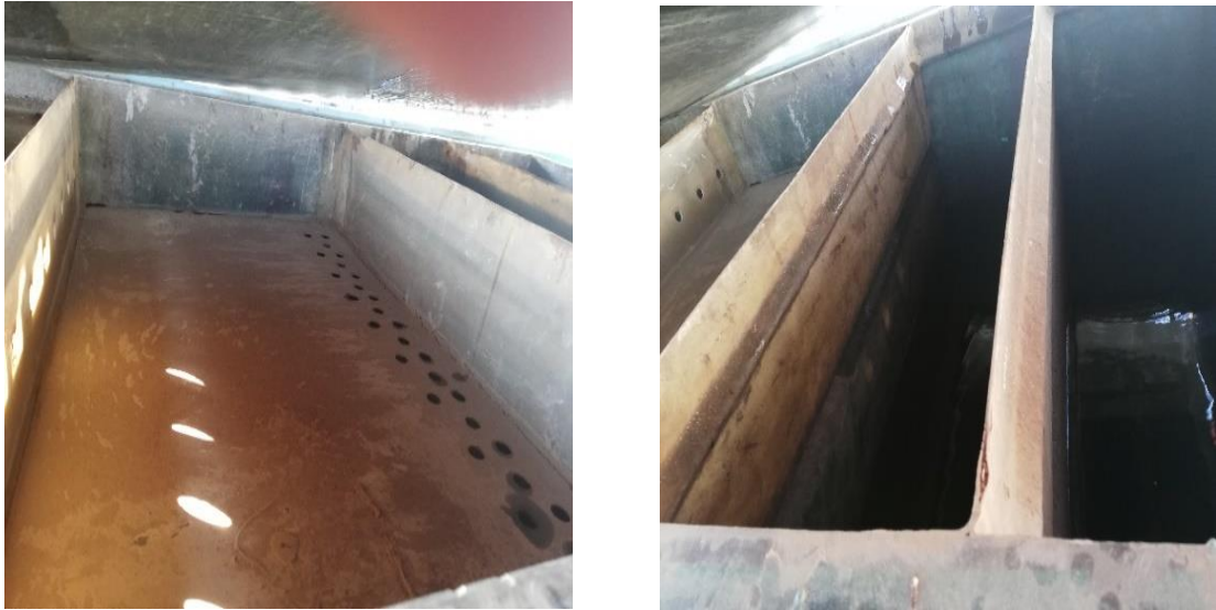
Figura 12. Interior del sedimentador- floculador y pantalla afectada por la corrosión
