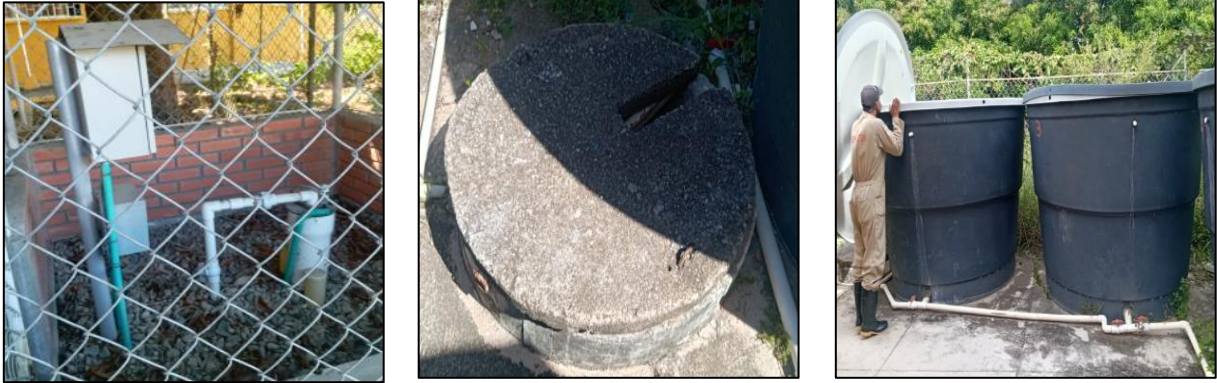
Figura 21. Suministro y almacenamiento de agua potable.
