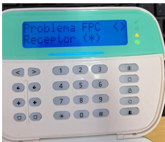
Figura 55. Teclado con alarma de falla en receptor. Fuente: propia.
