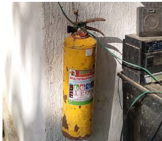
Figura 26 Estado del equipo contra incendios (extintores) PTAR
