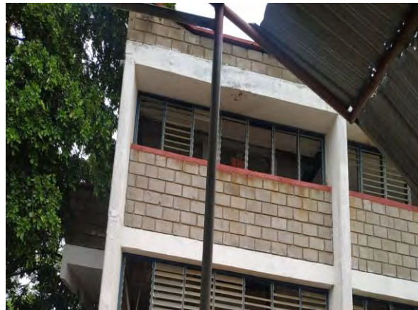
Figura 17 Infraestructura Planta de Tratamiento de Agua Potable-PTAP
