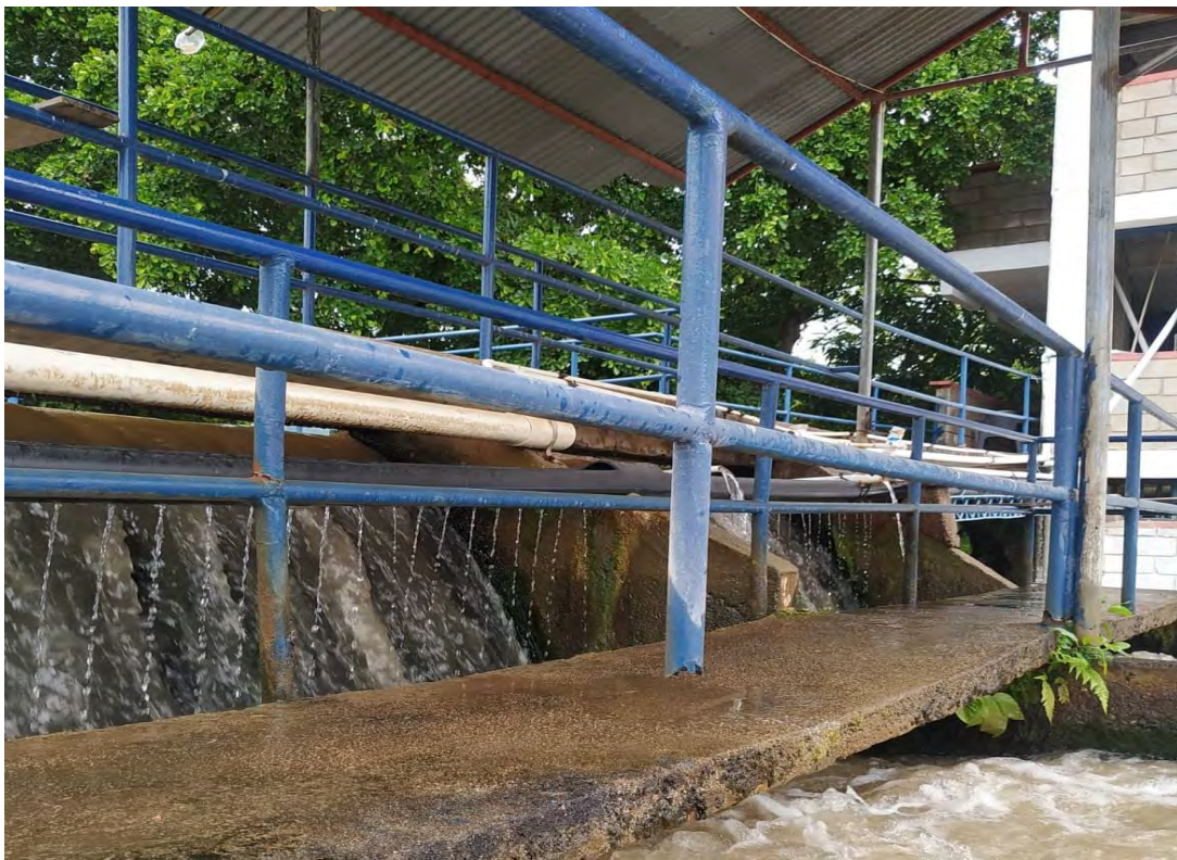
Figura 38 Planta de Tratamiento de Agua Potable- PTAP
