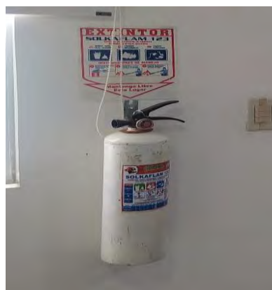
Figura 9 Estado del equipo contra incendios (extintores) Sede Administrativa
