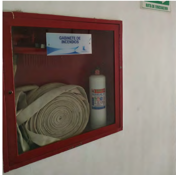
Figura 10 Estado del equipo contra incendios (extintores) Sede Administrativa
