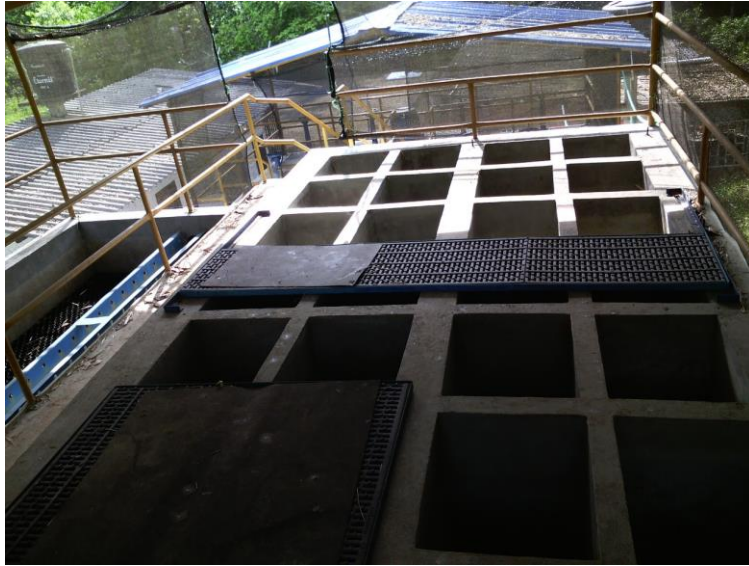
Foto 3 Filtración PTAP El Castillo meta
