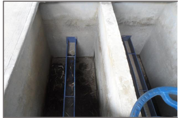
Ilustración 15 Filtros ascendentes vista superior Fuente: Autores 2016.
