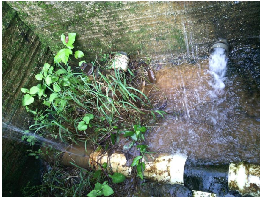
Foto 8 Línea de conducción con presencia de fugas
