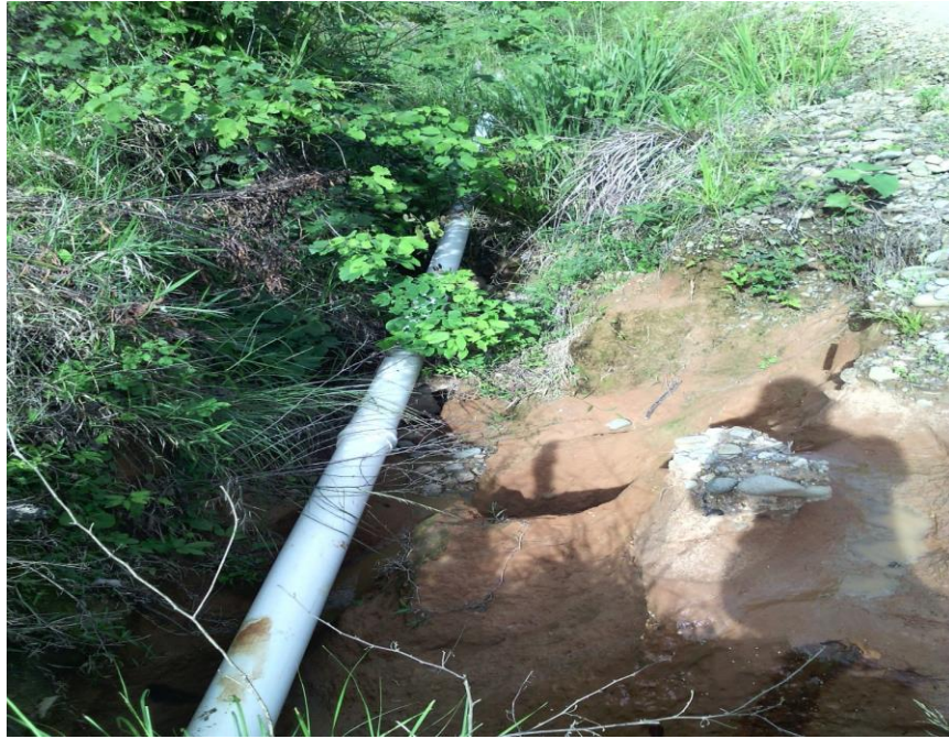
Foto 7 Línea de conducción con por zona erosionada
