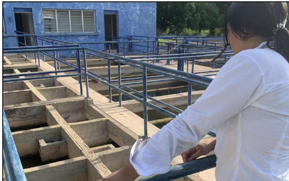
Cámaras de Floculador Tipo Alabama
