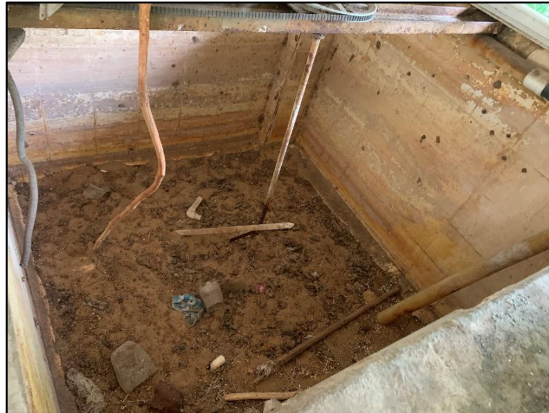
Tanque para Preparación de Solución de Coagulante
