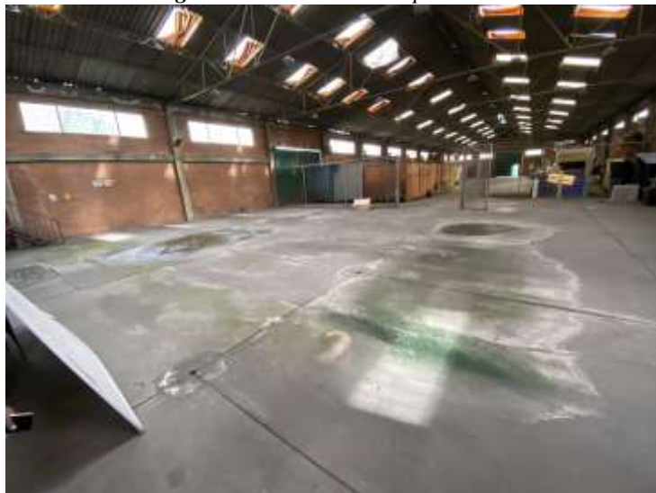
Figura 36. Moho causado por lluvias
