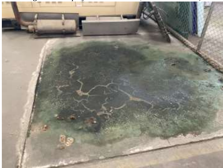
Figura 33. Superficie deteriorada (cubierta de moho)
