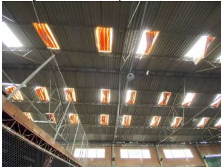
Figura 35. Techado de bodega del IPSE (Mal estado)
