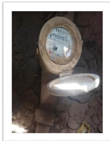
Medidor de agua del parque de la provincia.
