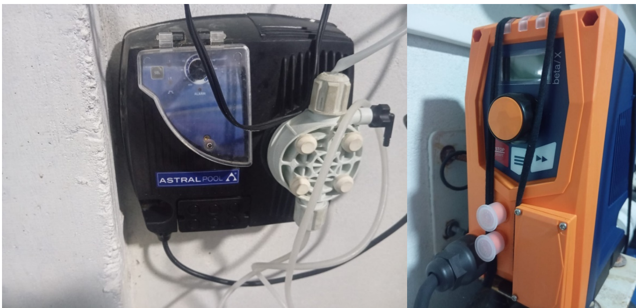
Fuente: elaboración propia - antes y después de sistema de bomba dosificadora de cloro.
