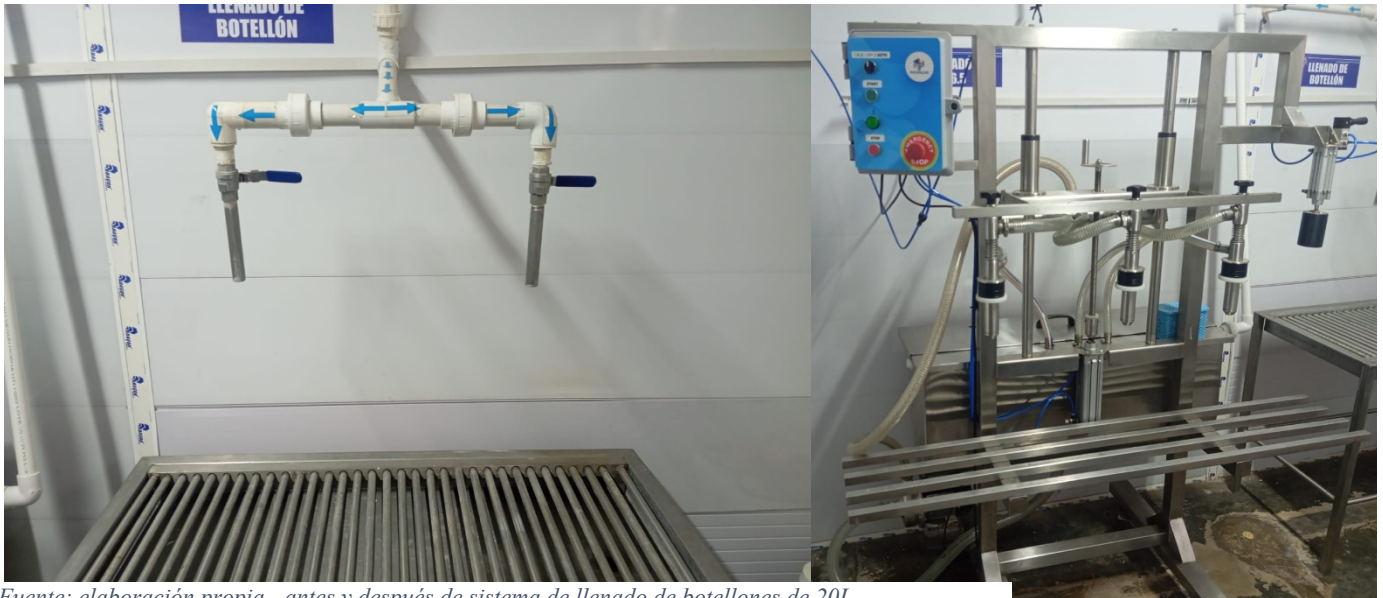
Fuente: elaboración propia - antes y después de sistema de llenado de botellones de 20L
