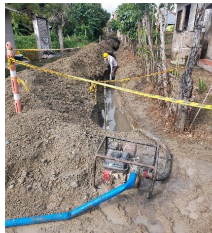
Figura No. 13. Evacuación de aguas servidas estacadas en excavación de callejón #2, sector las flores para instalación de tubería PEAD D=90 mm
