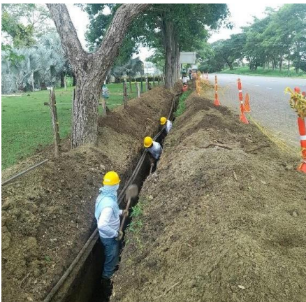
Figura No. 11. Excavación a mano en tramo troncal, sector cogasucre para instalación de tubería PEAD D=250 mm.
