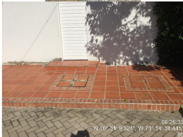
Figura 22. Ubicación tanques sépticos (Área de oficinas)
